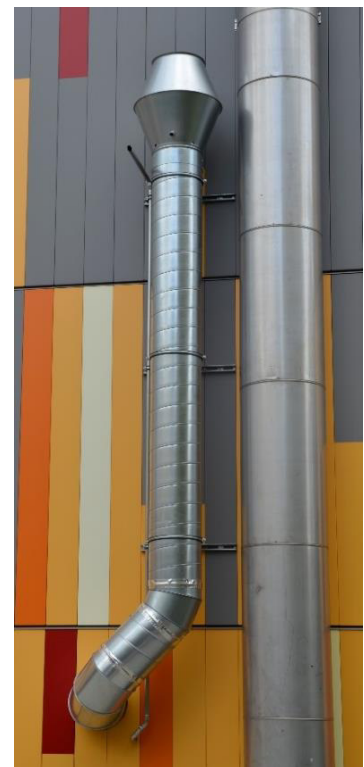
Abbildung 3-12: Fortluftkamin an der Gebäudeaußenwand
