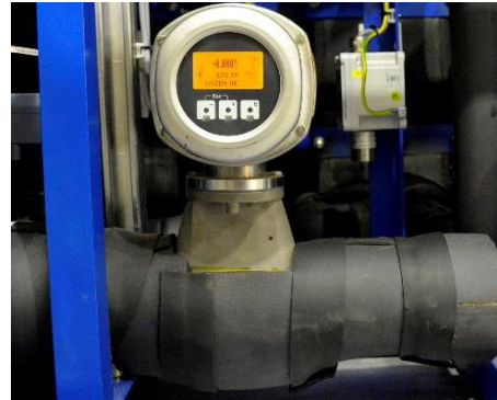
Abbildung 3-18: Einbausituation des Massendurchfluss-Messgerätes
