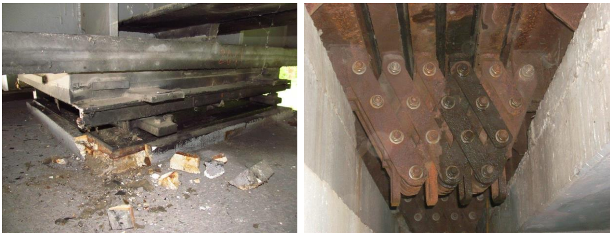
Abb. 3 – beschädigtes Lager und Fahrbahnübergangskonstruktion der Steyregger Brücke (ÖÖ) (Vgl. Landesrat Steinkellner [2016])
