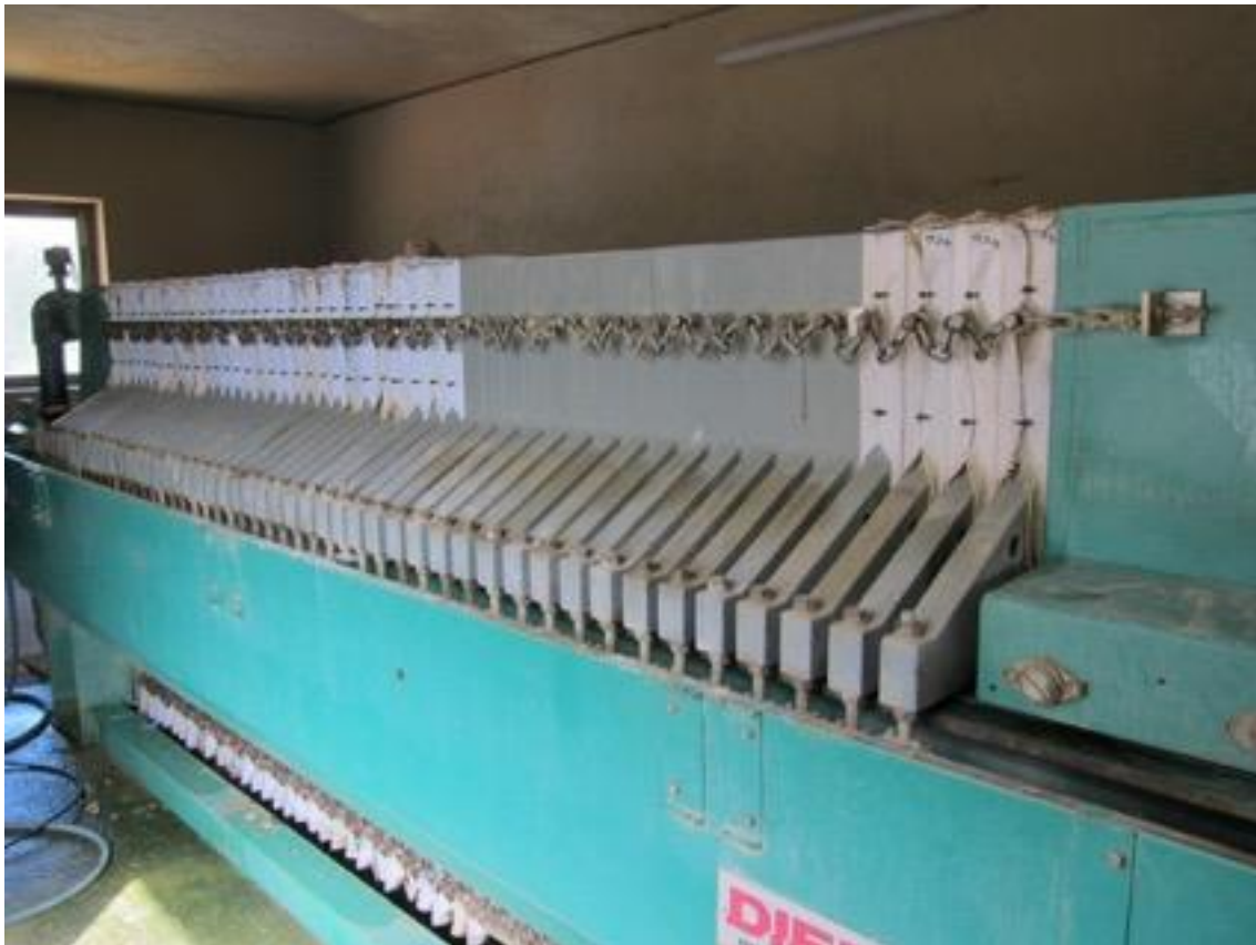
Abb. 11: Detailaufnahme Kammerfilterpresse im Auspressvorgang
