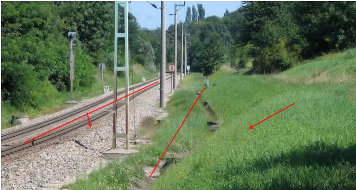
Abb. 116: Zuggleis angrenzend an einen Kriechhang mit erkennbaren Schäden. (Leopold, 2012)
