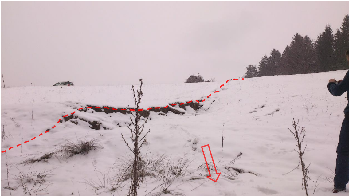
Abb. 34: Rutschung Krauth: Entlang der Anrisskante ist ein deutlicher Höhenversatz zwischen bestehendem und fließendem Gelände sichtbar. (WLV Kärnten)
