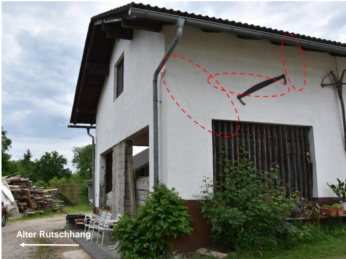
Abb. 164: Traktorgarage mit Risschäden Blick Richtung Nordwesten
