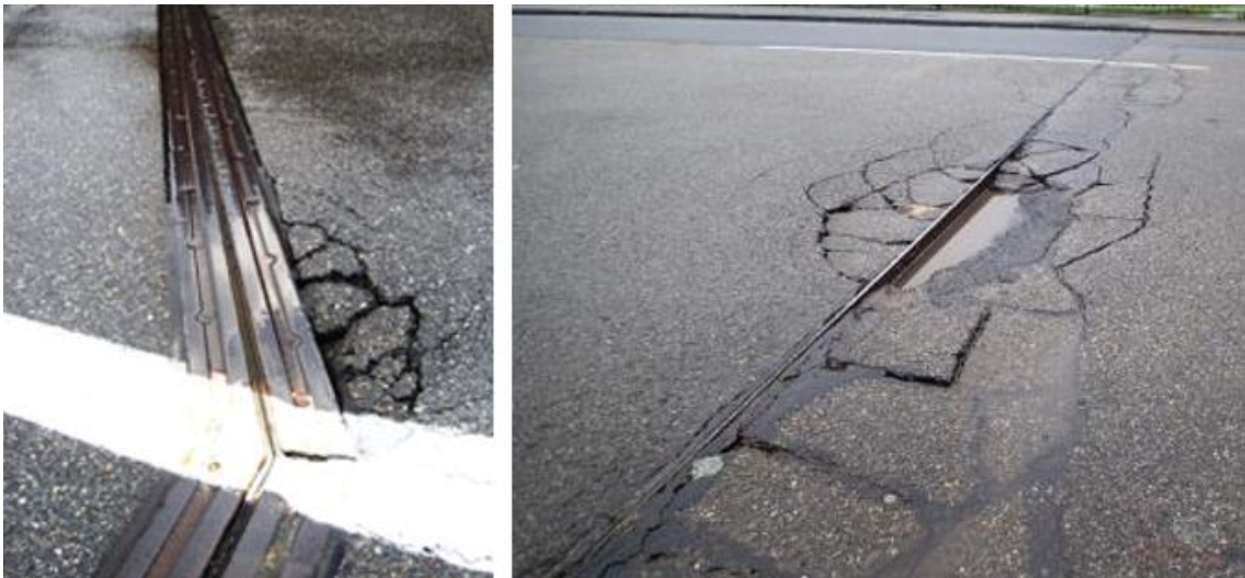
Abb. 122: Asphaltbrüche bzw. -risse an einer Fahrbahnübergangskonstruktion 59
