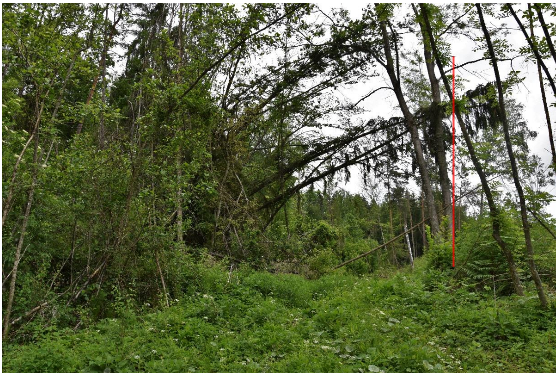
Abb. 154: Im Bereich der unteren Rutschzone sind Bäume durch die Rutschung teilweise umgebrochen, hängend an anderen Bäumen oder schiefgestellt.
