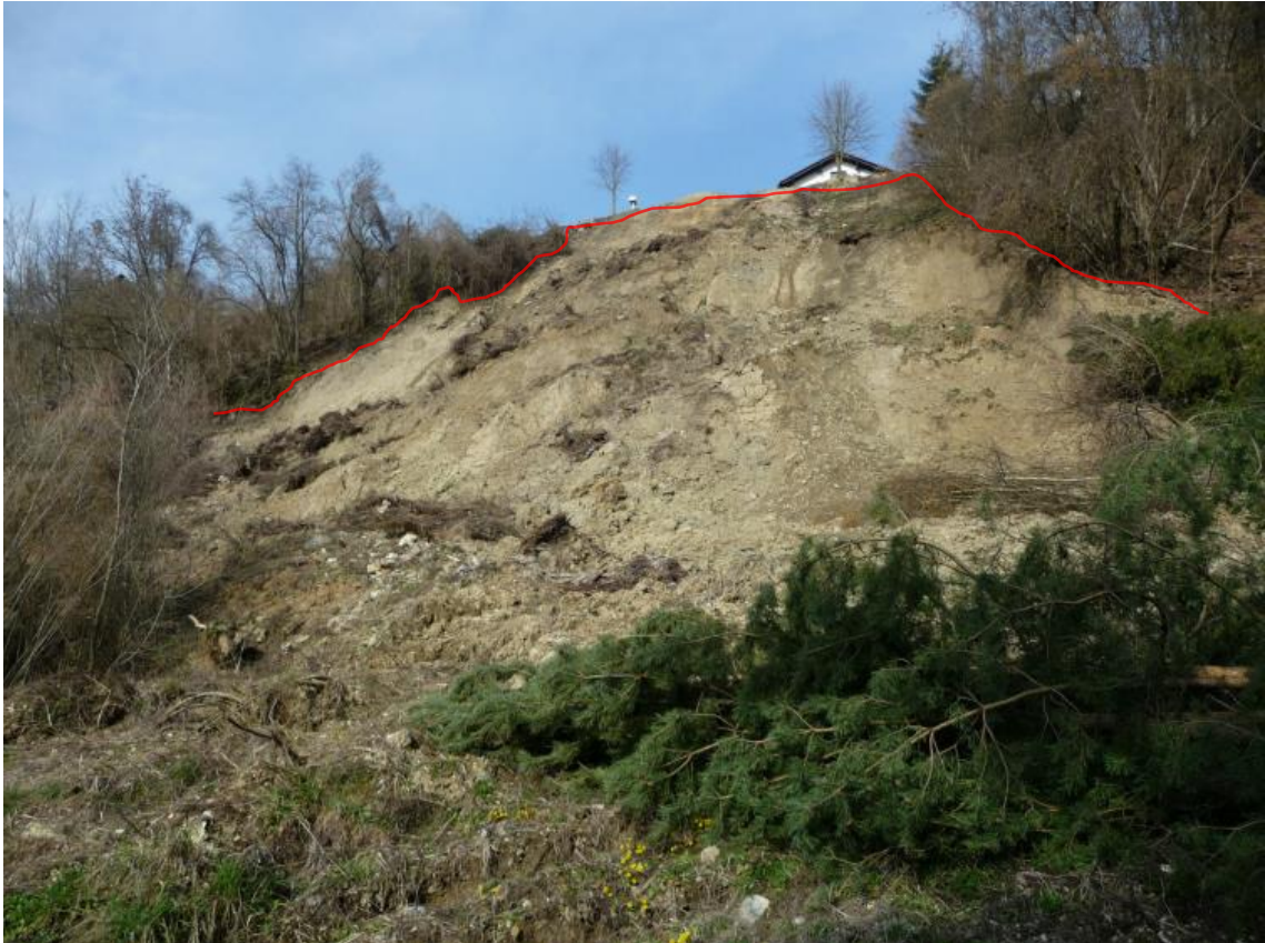
Abb. 142: Obere Steilstufe mit Blick auf die Anrisskante unmittelbar nach dem Rutschereignis (WLV Kärnten, 2014)
