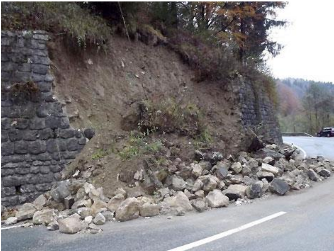
Abb. 63: Stützmauerversagen durch den einwirkenden erhöhten Erddruck 26
