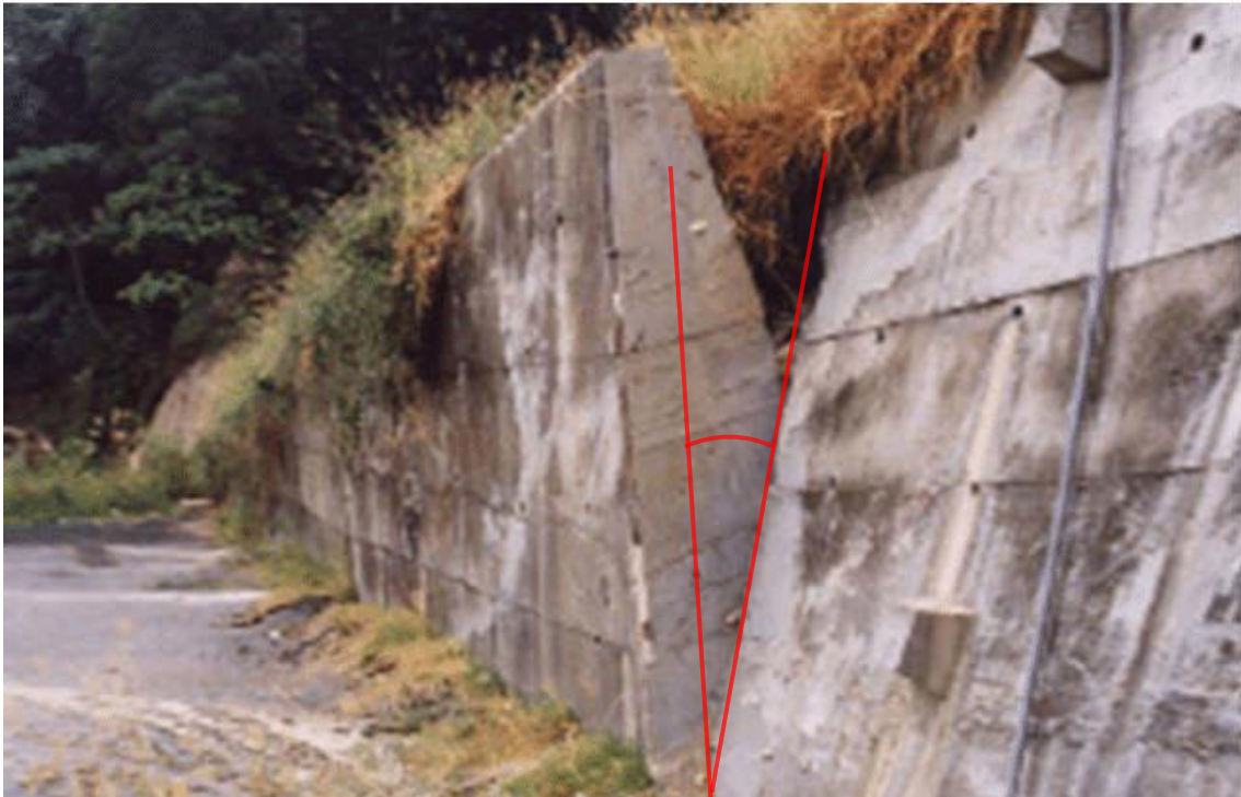
Abb. 105: Neigungsänderung einzelner Stützmauerblöcke 49
