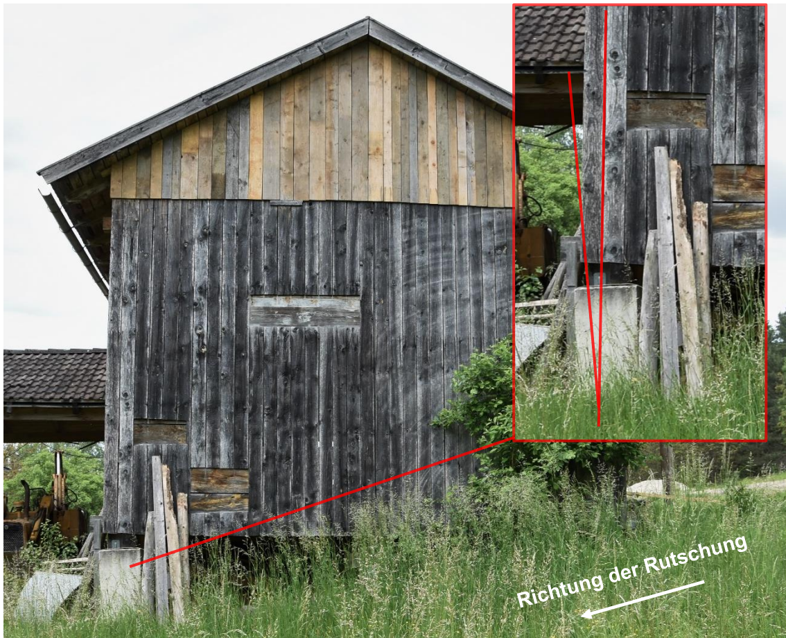
Abb. 168: Stallgebäude südlich unter dem Rutschungsende; Blick Richtung Westen; Darstellung der Neigungsunterschiede von Betonwand und Bauwerk im Detail
