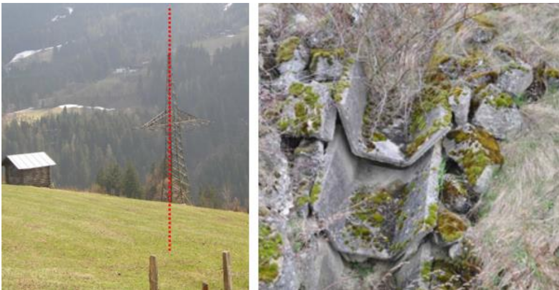
Abb. 70: Links: Neigungsänderung Strommast (Breyman, 2014); rechts: geschädigte Entwässerungsrinne aufgrund von Kriechbewegungen im Untergrund 32
