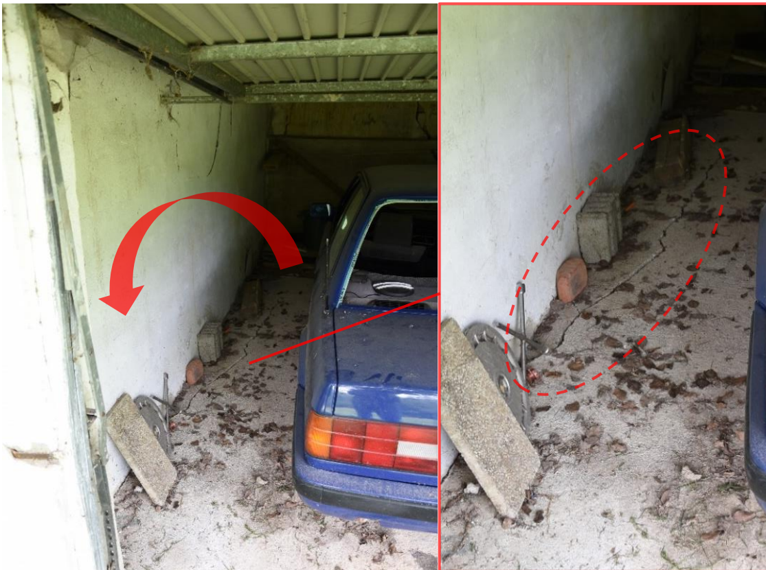
Abb. 172: Linkes Bild: Risse in der Bodenplatte aufgrund von Kippen der inneren Wand; Rechtes Bild: Risschaden im Detail
