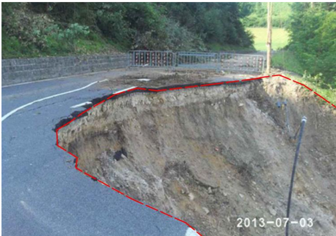
Abb. 38: Rutschung Mondsee: Die Anrisskante der Rutschung verläuft durch eine Straße wodurch ein Teil der Straße mit den bewegten Massen wegrutschte. (Steinbacher, 2014)
