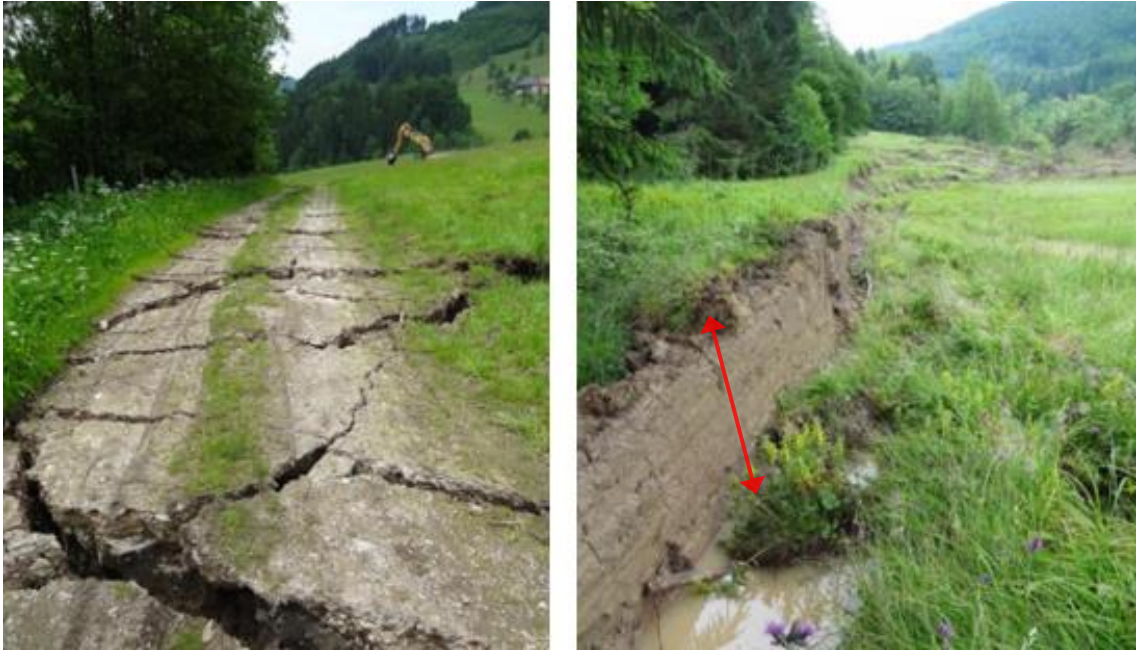
Abb. 84: Links: offene Risse im Boden; rechts: Anrisskanten mit Höhenversatz des Geländes im Meterbereich (Gasperl, Tartarotti, 2014)
