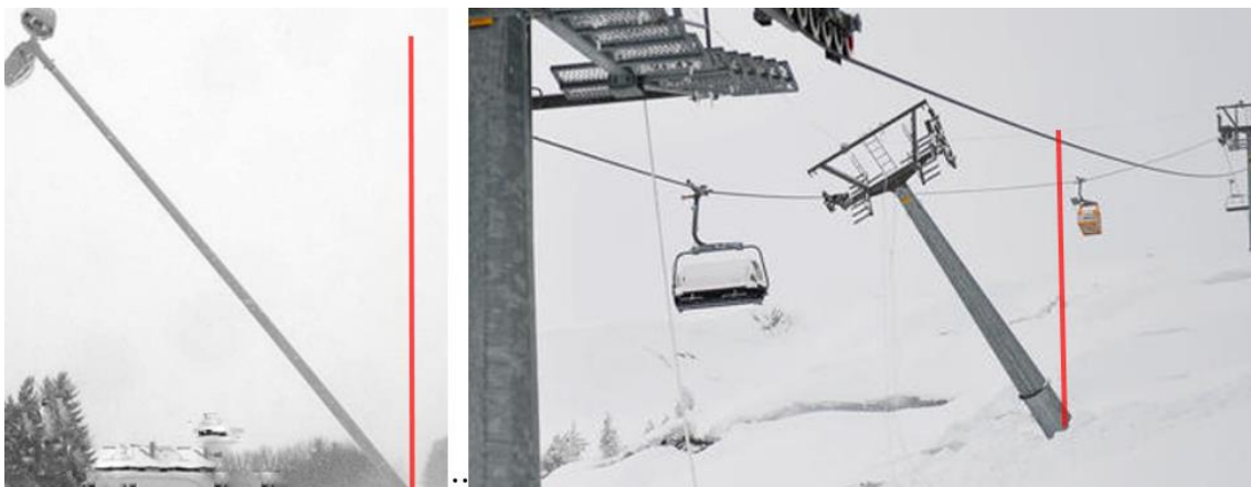
Abb. 128: Verdrehter Lichtmast links 62 ; Neigungsänderung einer einzelnen Liftstütze rechts 63
