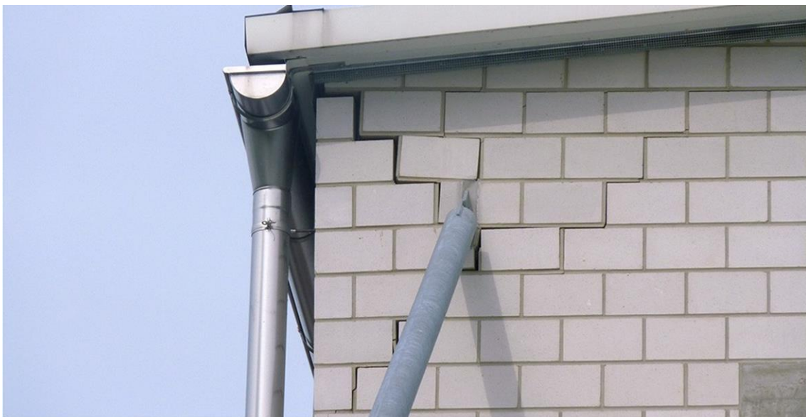
Abb. 100: Risschäden im Mauerwerk infolge von Verformungen 46
