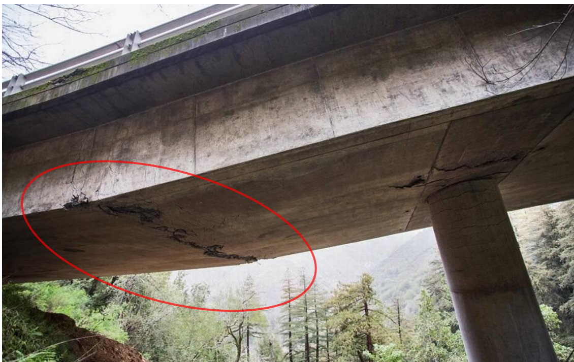
Abb. 118: Biegerisse am Tragwerk aufgrund des Ausfalls der Stützwirkung 57
