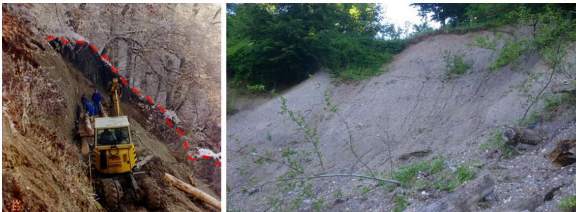
Abb. 32: Links: Aufnahme der Rutschung Wernberg während durchgeführter Sanierungsarbeiten. Gut erkennbare Steilstufe der Rutschung. Rechts: Rutschungsgebiet mit feinkörnigem Material mit Blick auf die Anrisskante und Steilstufe (WLV Kärnten)
