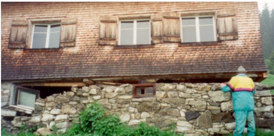
Abb. 132: Verformungen an der Holzkonstruktion und Schäden am erdberührten Mauerwerk verursacht durch kriechende Bewegungen des Hanges (Jaritz, 2001)
