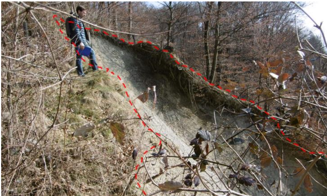
Abb. 31: Rutschung Wernberg: Abbildung der Anrisskante mit der sehr steilen Abbruchfläche. (WLV Kärnten)
