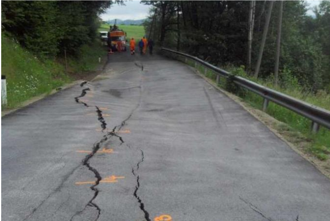
Abb. 62: Deutlich erkennbare Risse in der Straße verursacht durch Kriechen des angrenzenden Hanges (Steinbacher, 2014)
