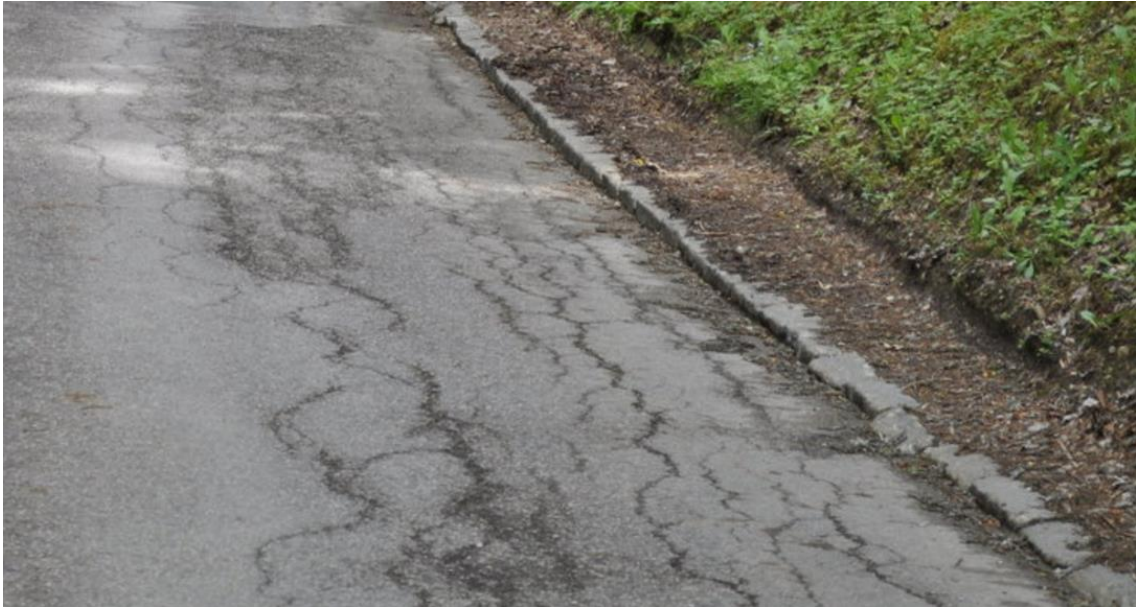
Abb. 131: Risse und Verwerfungen am Parkplatz angrenzend an die Skipiste 65
