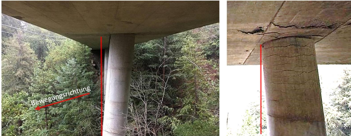
Abb. 117: Linkes Bild: Verschiebung eines Brückenpfeilers; Rechtes Bild: Risschäden im Stützbereich 56
