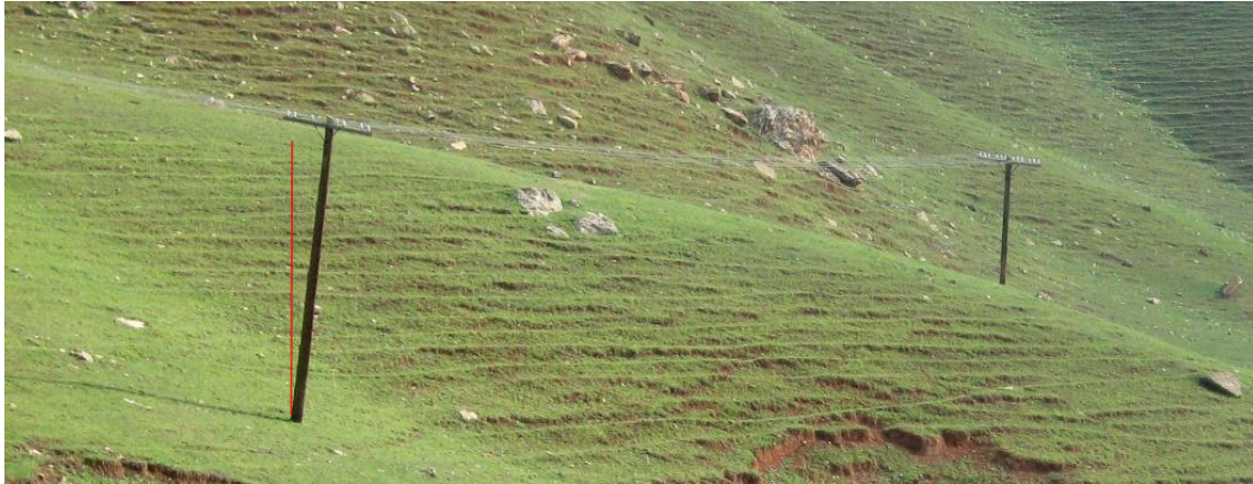
Abb. 114: Verdrehungen des Strommasten, sowie Bodenunebenheiten und erste Anrisskanten erkennbar 55
