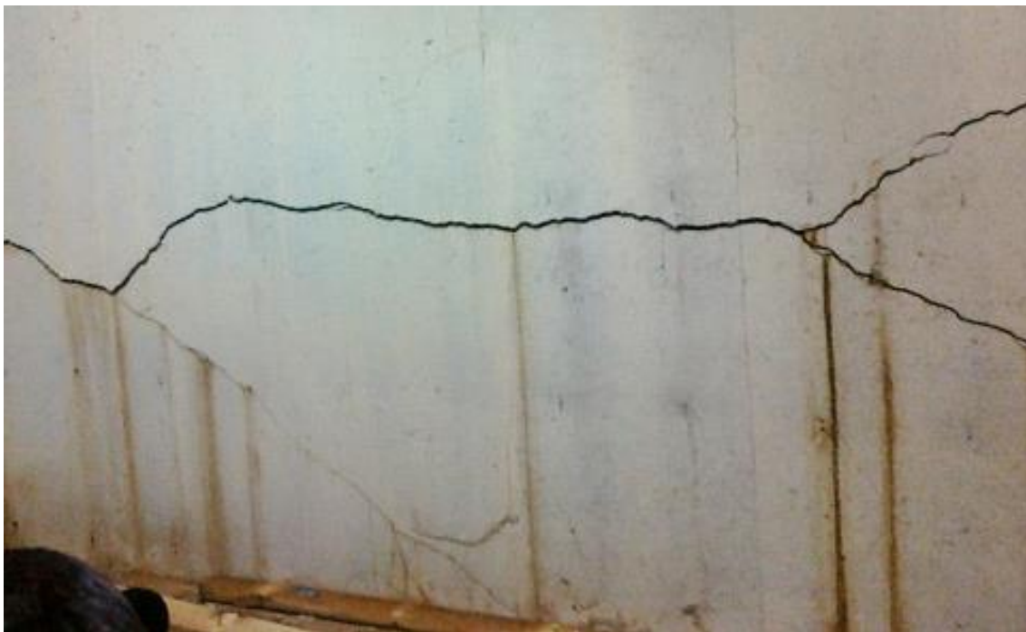
Abb. 130: Risse am Parkhaus ausgelöst durch den erhöhten Kriechdruck, der auf das Gebäude einwirkt 64
