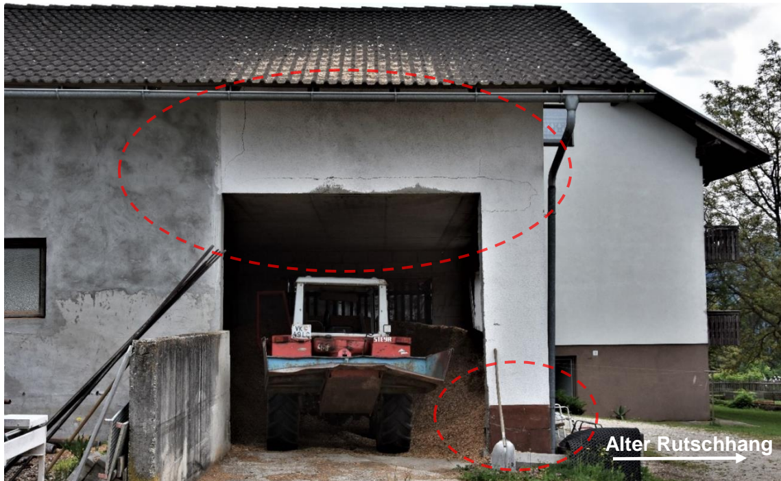
Abb. 162: Traktorgarage mit auffälligen Rissen, Blick Richtung Osten
