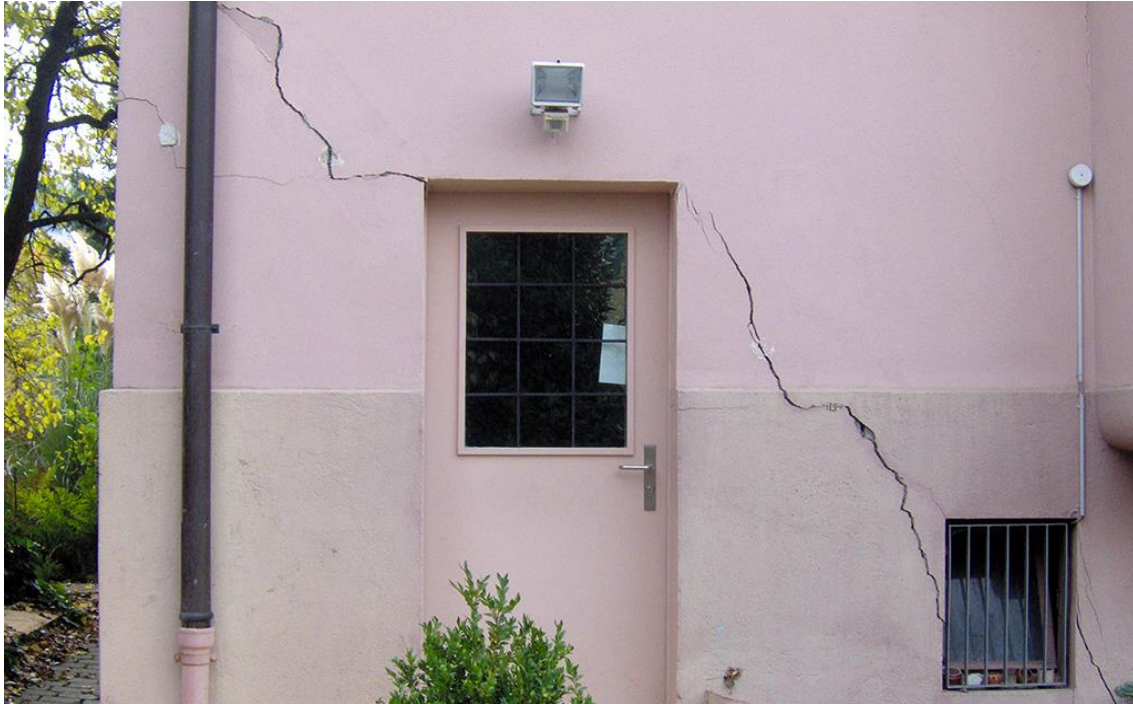
Abb. 99: Setzungsrissse an einem Gebäude 45
