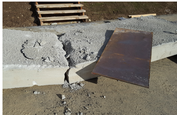
(d) Exposed failure zone.
