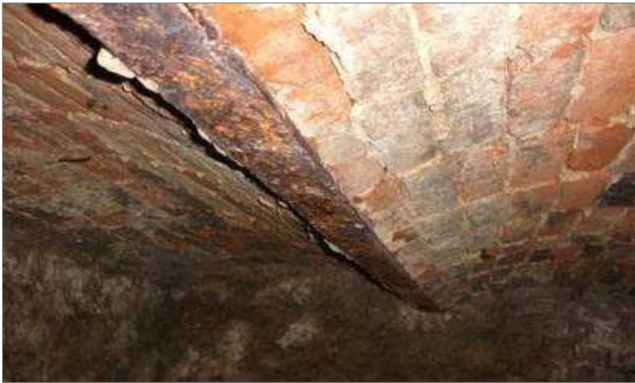
Bild 3.16 Korrodiertes Stahlträger einer Kappendecke 198
