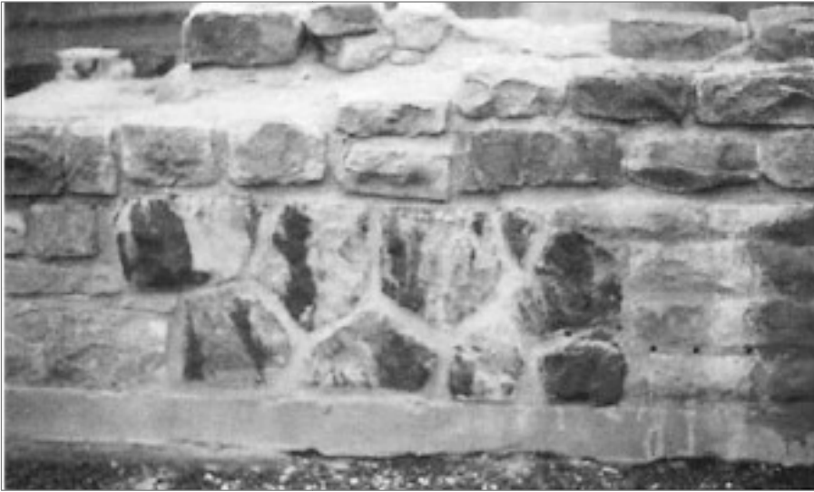
Bild 3.18 Bindemittelauswaschung an Natursteinmauerwerk 201
