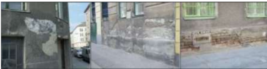
Bild 3.17 Feuchtigkeitsschäden im Sockelbereich 199
