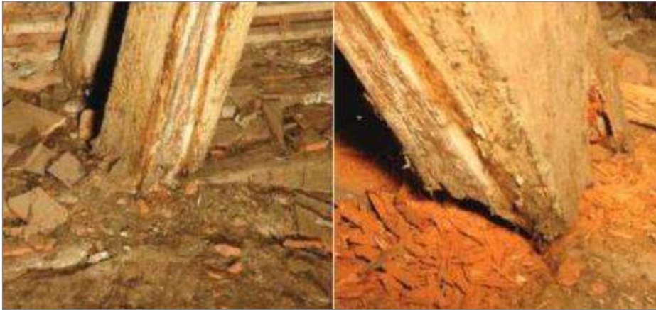
Bild 3.32 Zersörter Sparrenfuß vor (links) und nach Bearbeitung mit Hammer (rechts) 251
