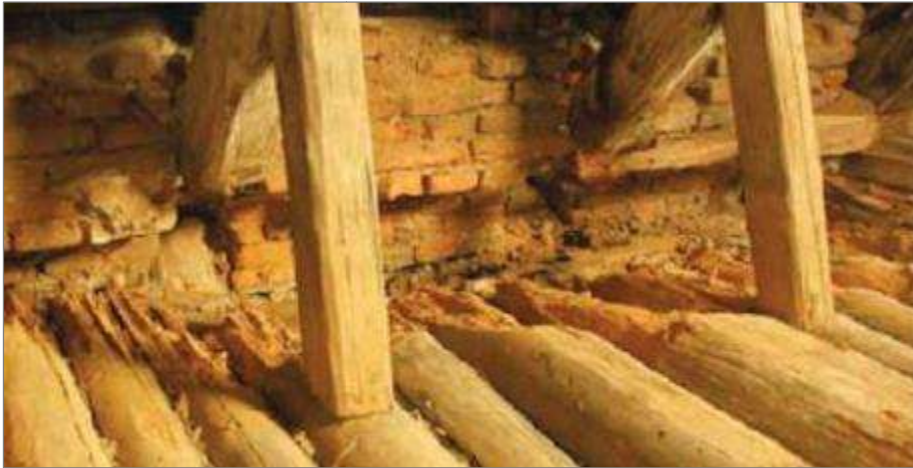
Bild 3.21 Zerstörte Balkenköpfe im Auflagerbereich einer Dippelbaumdecke unter Dachgeschoss 231
