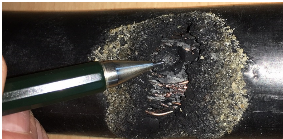
Abbildung 3.13: Fehlerstelle nach Erdschlussversuch
