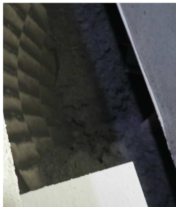
Motorstop des Mixers aufgrund der zu hohen Viskosität des Frischbetons
