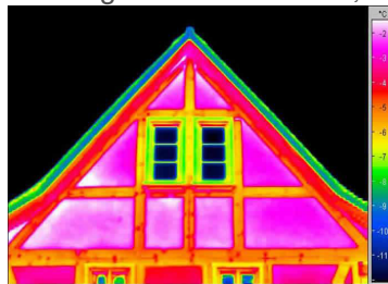
Bild 4.3 Thermografie eines Fachwerkhouses 336
