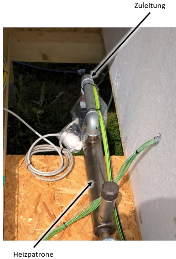
Abbildung 4-6: Heizregister zum Einstellen der Vorlauftemperatur
