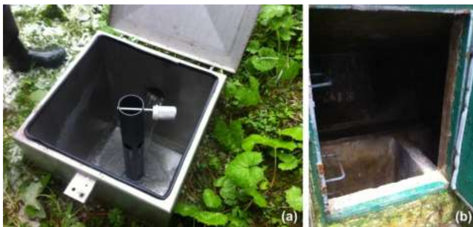
Abbildung 27 Beispiele für gefasste Quellen für die Wasserversorgung . (a) EPQ30 (b) EPQ32.
