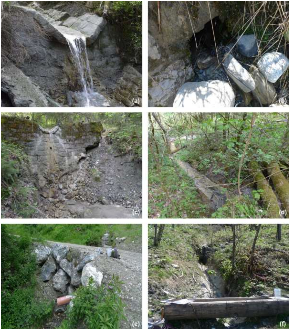
Abbildung 23 (a) künstlicher Geländesprung bei EPA01. (b) Drainagierzufuß bei EPA08. (c) Künette bei EPA16 – Zufluß zur Salzach. (d) Tagwasserschalenabau ab EPA17 und Zufluß zum Hauptgerinne kurz vor EPA16. (e) EPQD02 – Beginn der Tagwasserschaltung. (f) Tagwasserschale bei EPA08
