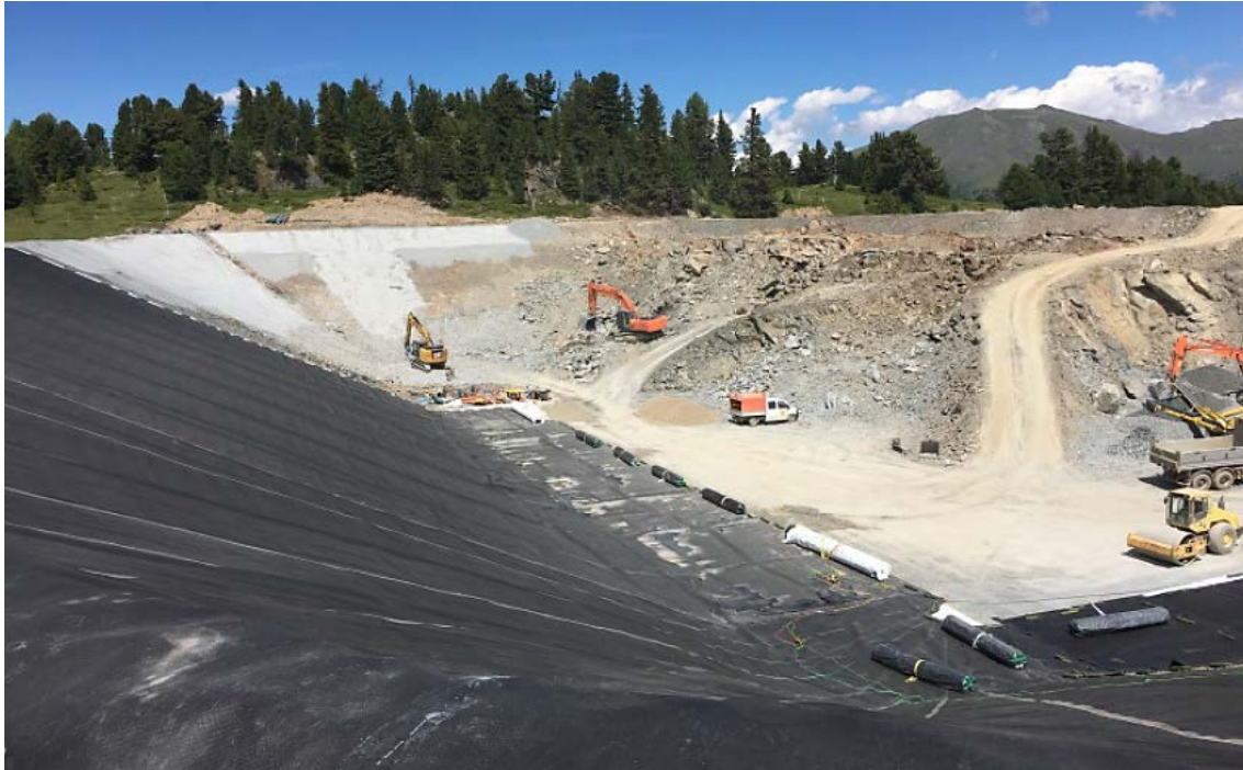
Abbildung 5-9: Speicherabdichtung mittels PEHD-Folie [84]
