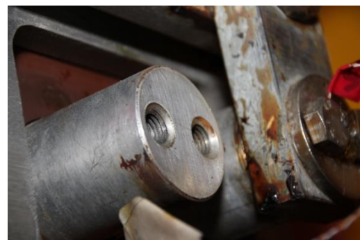
Bild 3-44 – BV 2: Kontakt Primärleiter vor Umbau
