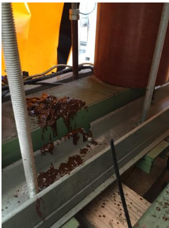
Bild 3-18 – BV 1: Abgetropftes Leiterschmiermittel
