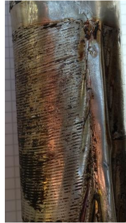
Bild 3-21 – BV 1: Leiterseilabschluss Nahaufnahme
