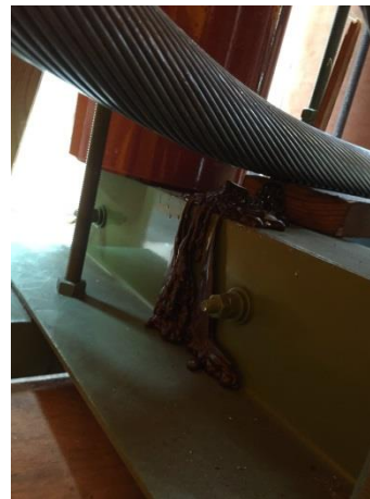
Bild 3-19 – BV 1: Ausgelaufenes Leiterschmiermittel
