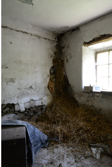
Beschädigte Steinmauer Eingefallener Ofen
