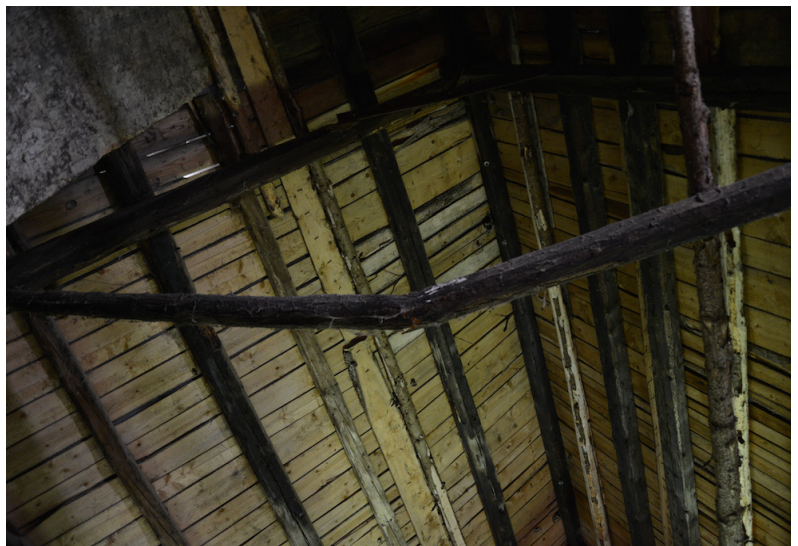
Abbild 3.4.26 Beschädigter Dachbalken
