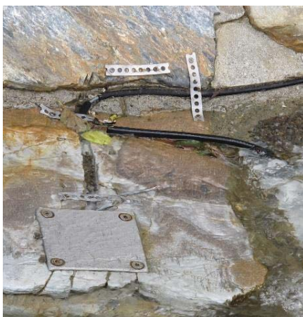
Abbildung B 2-13: Kabelbruch August 2016
