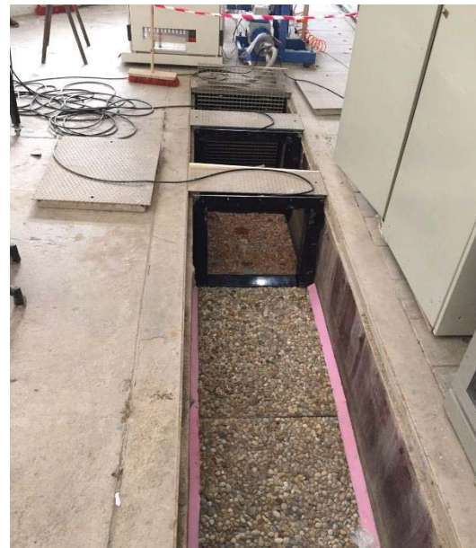
Abbildung C 2-3: Gerinne mit eingebauten Antennen
