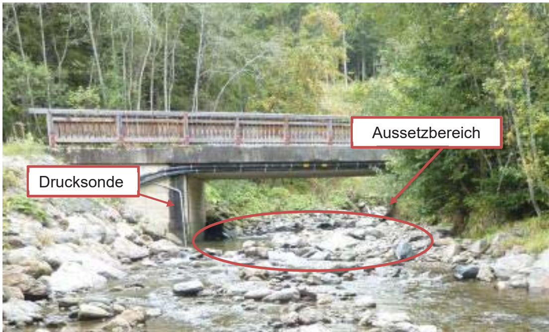
Abbildung A 9-8: Pegelmessung Brücke Schöttlbach
