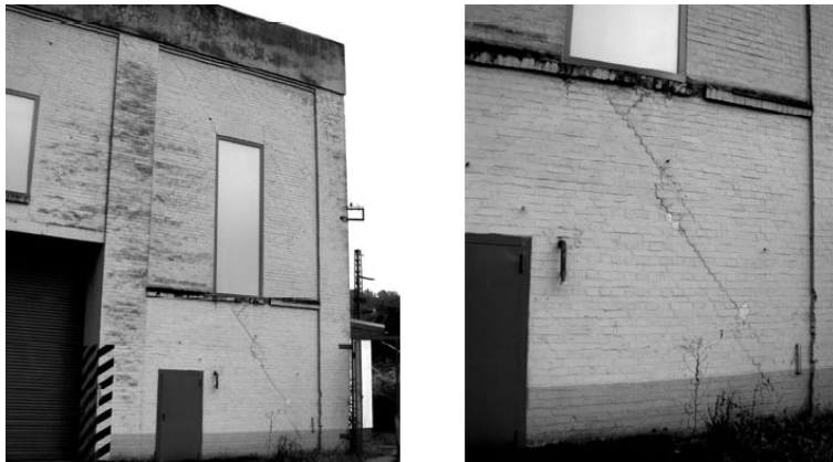
Abbildung 4: Beispiel für setzungsbedingte Risse am Mauerwerk 9
