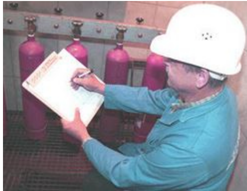
Abbildung 16: Inspektion der Feuerlöscher 31
