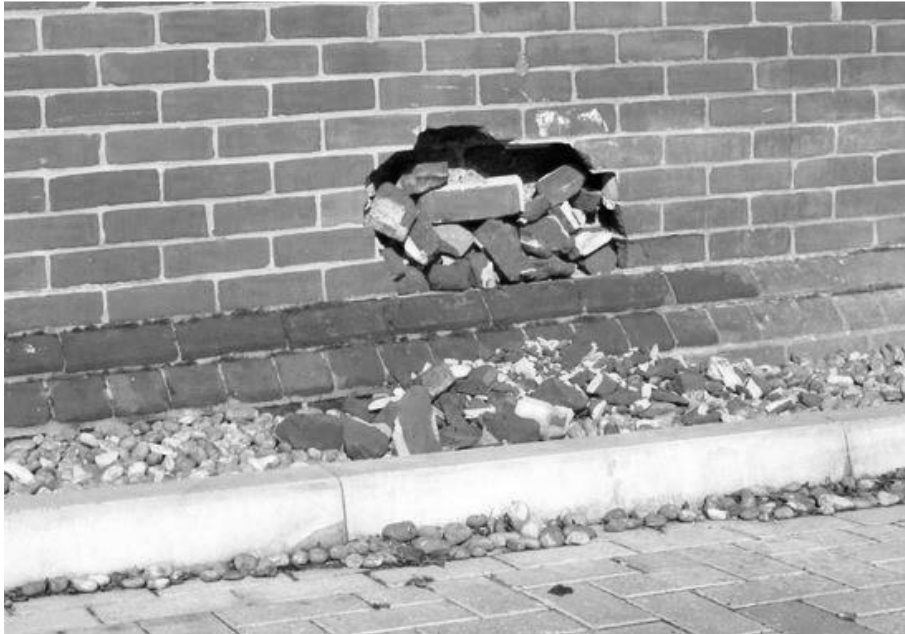
Abbildung 6: Beispiel für Anprall an Mauerwerk 11
