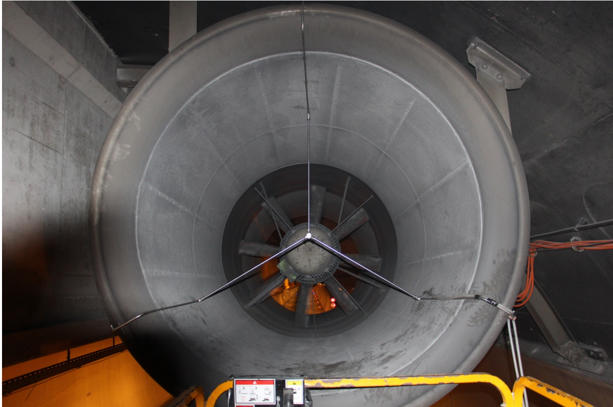
Abbildung 3-15: Einbausituation Flügelsonde im Strahlventilator SL 5.1
