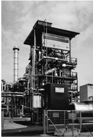
Abbildung 2. bioCRACK-Pilotanlage der Firma BDI BioEnergy-International AG in der OMV Raffinerie Wien/Schwechat [34].
