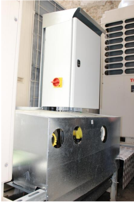
Schaltschrank mit Messsensoren (t, p, \dot{m} ) der Nordtraktkreise (AG8 & AG9)
