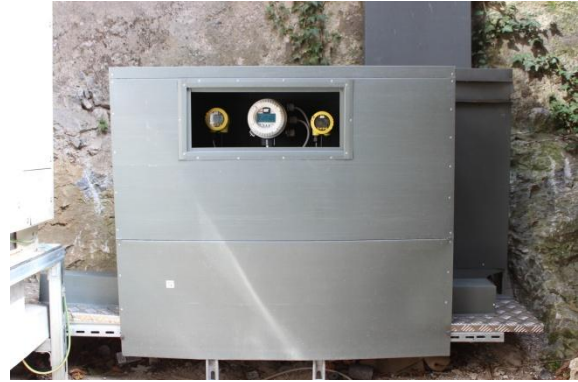
Messsensoren (t, p, \dot{m} ) des Schlosstraktkreises (AG3)
