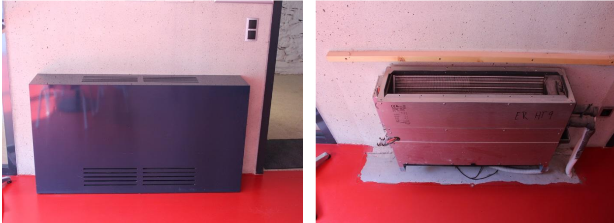
Abbildung 28: Innengerät in der Bar (AG8) links: mit Verbau rechts: ohne Verbau
