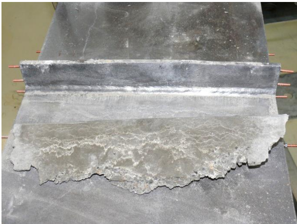
Bild 23 Untersicht zerstörter Betonkeil – Darstellung der Risslinien
