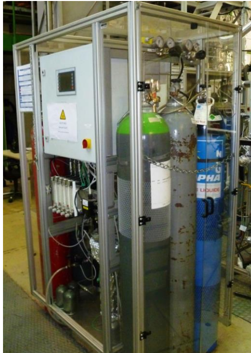
Abbildung 4-10: Foto der Gasregelstrecke
