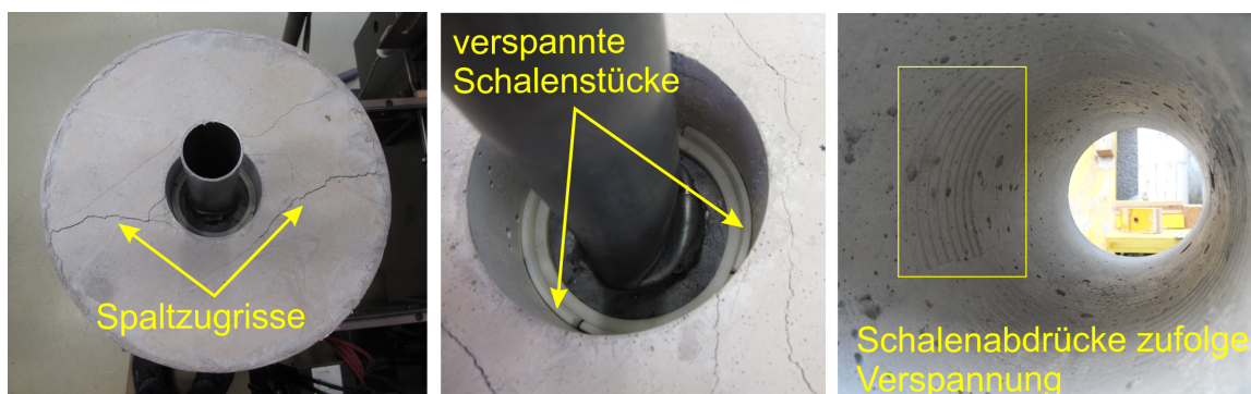
Abbildung 6.17: Bewehrter Betonkörper nach der Versuchsdurchführung; links: aufgetretene Spaltzugrisse an der Oberseite des Betonkörpers; Mitte: verspannte Schalenstücke; rechts: Abdrücke eines Spannschalensstückes in der Betonoberfläche zufolge des Verspannvorgangs
