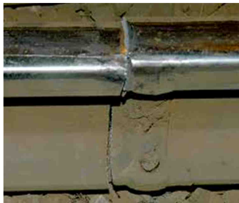
Abb. 1 Beispiel Schienenbruch ( Quelle: versa.bmvit.gv.at )
