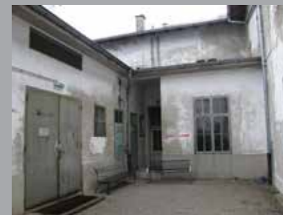
Kleiner Hof mit Trafo (3.6 + 3.5)
