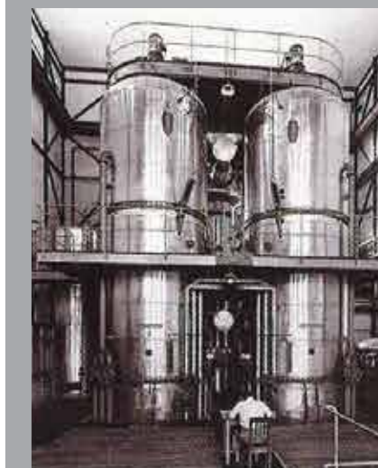
Abb. 68 Kompressorhalle mit drei Thermokompressoren zur Komprimierung des Kondensates zu Heißdampf, drei Elektromotoren für den Betrieb der Kompressoren.
