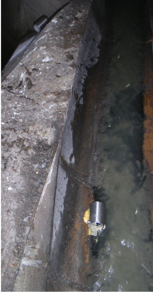
Abbildung 3-5: Eingebaute Temperatursensoren in einem Weizer MWÜ
