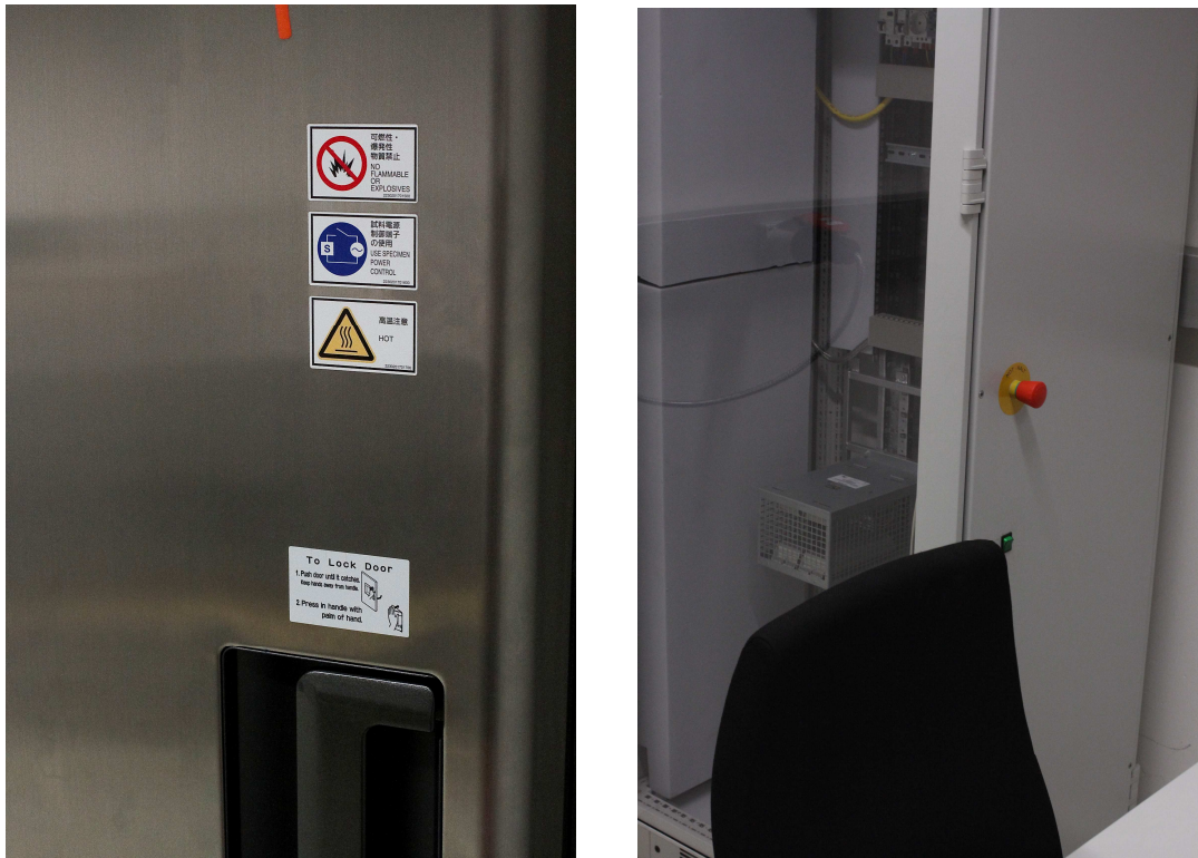
Abb. 60: Sicherheitseinrichtungen (links: Piktogramme / rechts: gesicherter Schaltschrank mit Schloss sowie Not-Halt-Taster am Arbeitsplatz)
