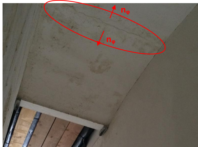
Abbildung 14 - Gewölbedecke als kurze Tonnenschale, Riss in Gewölbeachse infolge Zugkräfte n_\varphi , Scheitel, Laibungsseite, Bauvorhaben Stadthöfe Hamburg
