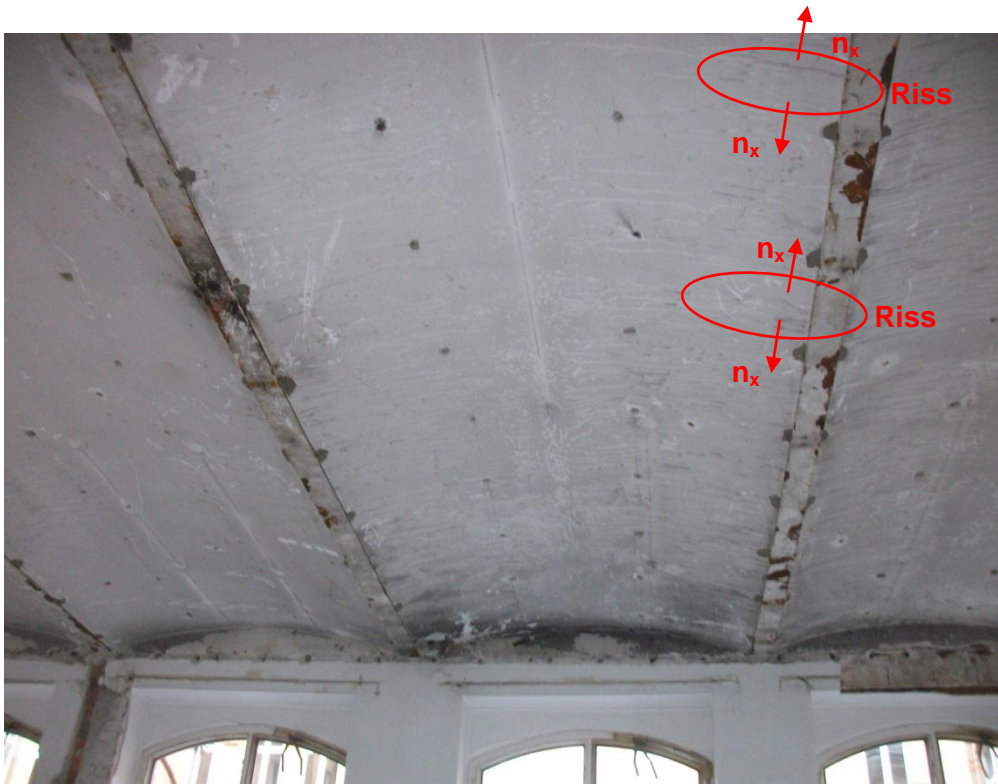
Abbildung 16 - Risse quer zu den Trägern im unteren Bereich der Kappe infolge Zugspannungen \sigma_x , Preußische Kappendecke, Bauvorhaben Stadthöfe Hamburg
