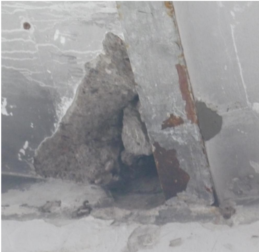
Abbildung 21 - Betonausbruch im Bereich eines Trägersauflagers, Bauvorhaben Stadthöfe Hamburg
