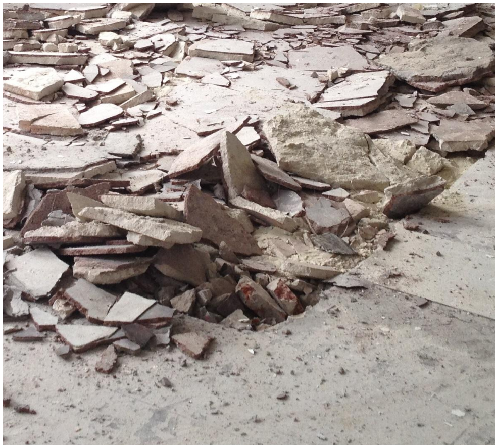
Abbildung 32 - Aufgebrochener Fußbodenaufbau, Betondruckplatte
