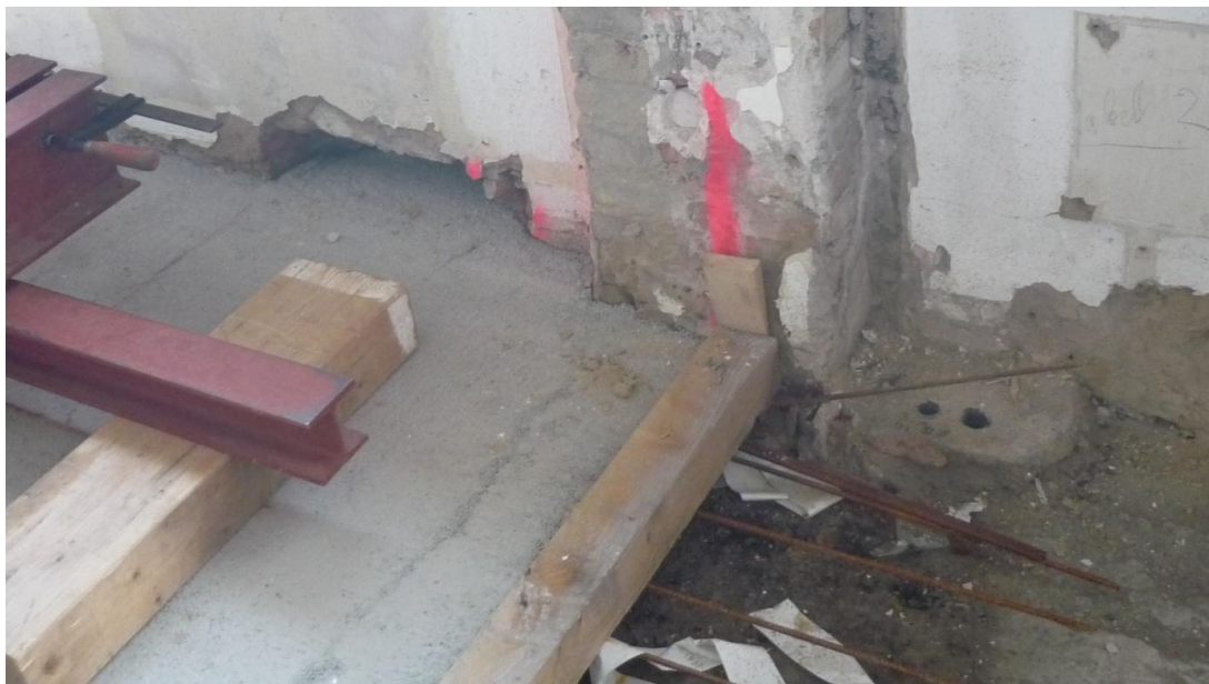
Abbildung 66 - System 1, neu hergestellte, mittige bewehrte LC-Druckplatte mit Auflagertasche. Rechts unten: Rücken des Betonkappenscheitels, links: Lasteinleitung des Versuchsaufbaus der exp. Tragsicherheitsuntersuchungen
