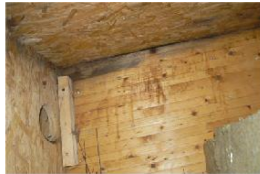
Abbildung 2.2: Wasserflecken, aus (Fellmoser, 2012)
