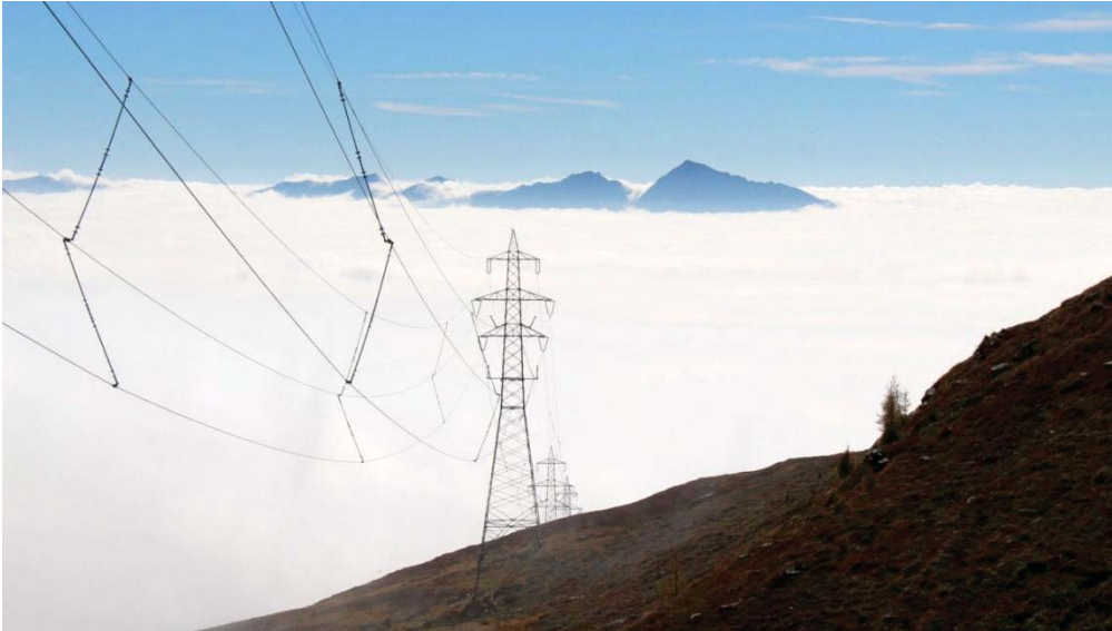
Abb. 8: Abschnitt 3 ist bereits mit Leitungsableitern ausgestattet: Blick von Mast 28 Richtung Süden zu den Masten 27 bis 25
