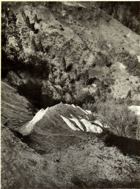
Tav. 46. — Parte destra della frana Cantarol guardando dall'alto al basso (sistemata).
