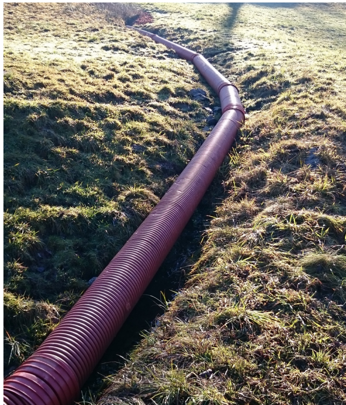
Abbildung 6: Typisches Drainagerohr zur Entwässerung der Piste
