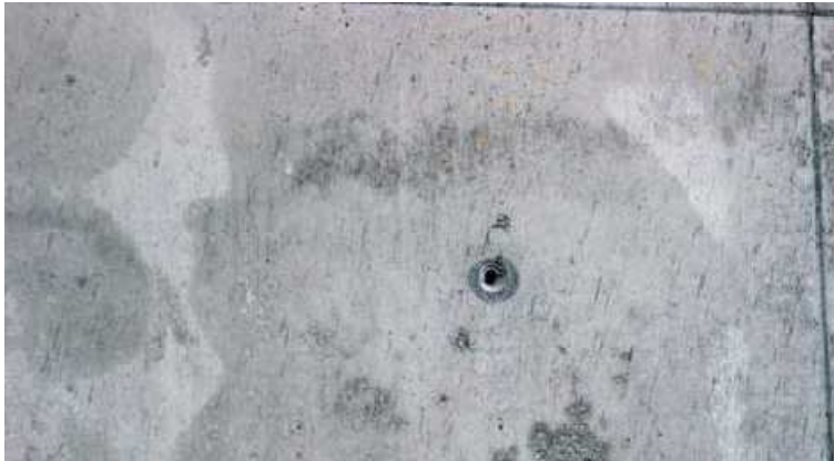
Bild 96 Ablösen der Zementhaut an der Betonoberfläche wegen eines zu frühen Öffnens der Schalung 509
