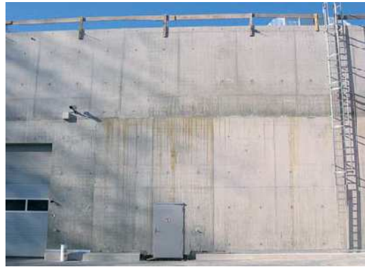
Bild 103 Rostspuren aufgrund ungeschützter Anschlussbewehrung 521
