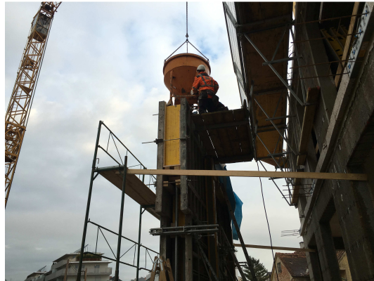
Bild 156 Ursache: Die freie Fallhöhe des Frischbetons beträgt 5,5 m
