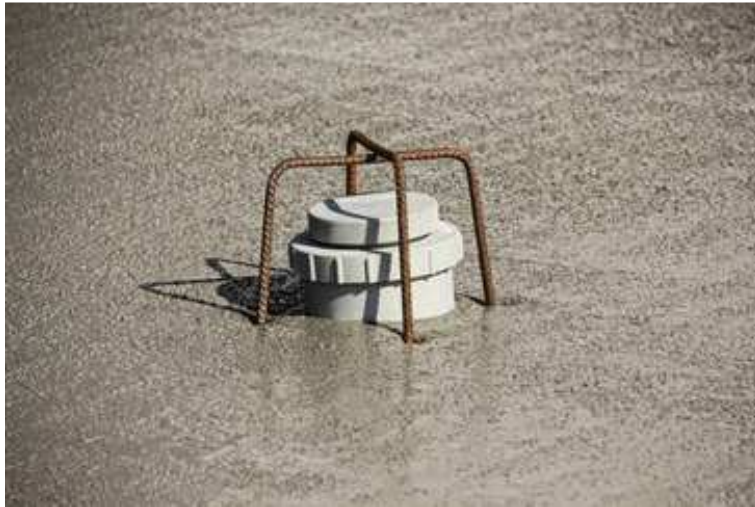
Bild 93 Einsatz Concremote Deckensensor 500
