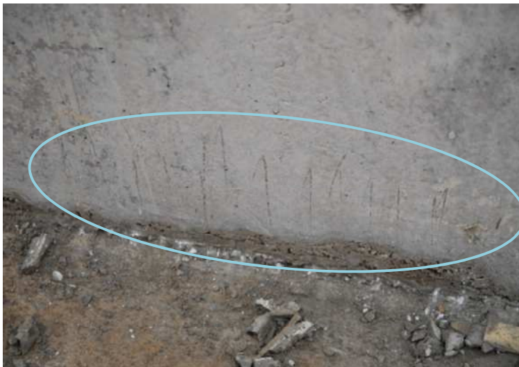
Bild 99 Kratzer im Wandfußbereich, da das Schalungselement beim Ausschalvorgang nicht vollständig von der Betonfläche abgerückt wurde 512
