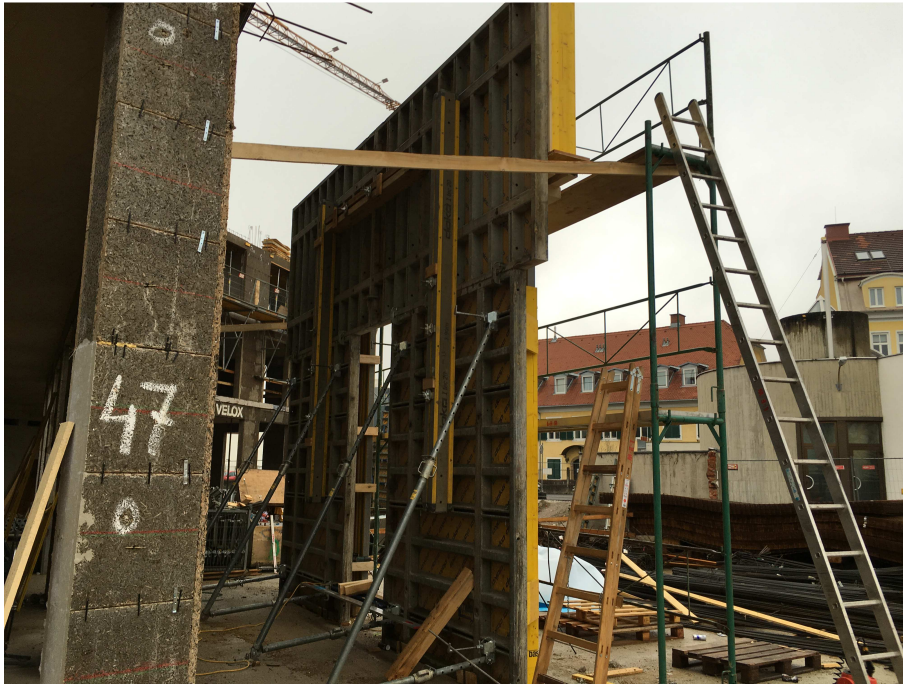
Bild 128 Rahmenschalung mit Spindelabstützung
