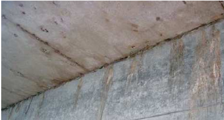
Bild 98 Verfärbungen der Betonfläche wegen einer zu langen Verweildauer in der Schalung 511
