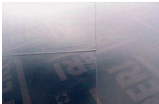
Bild 80 Aufgequollene Schalhaut (Ripplings) 458
