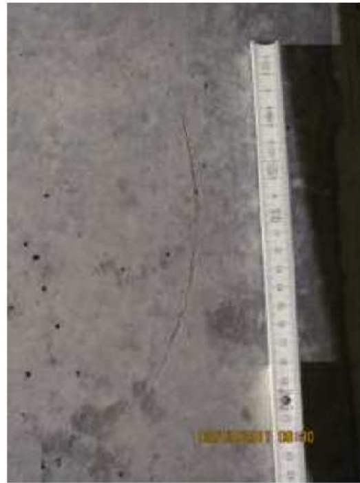
Bild 82 Wirkung: Kratzer auf der Betonoberfläche 460
