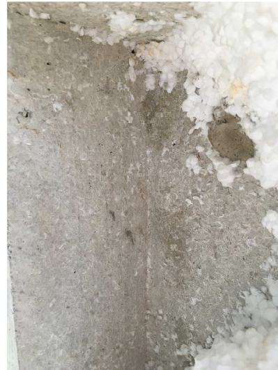
Bild 164 Wirkung: Anhaften der Polystyrolkügelchen auf der Betonoberfläche
