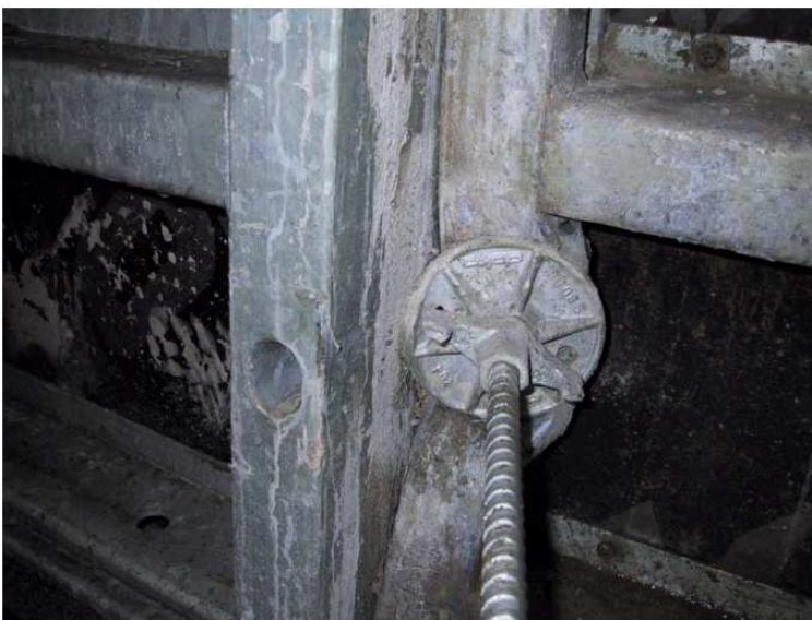
Bild 26 Auswirkungen von zu hohem Frischbetondruck 170
