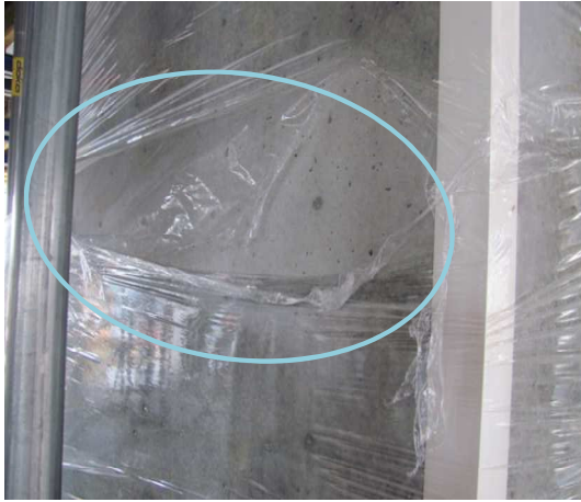
Bild 100 Anliegende und beschädigte Folie 518
