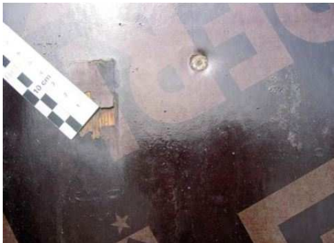
Bild 79 Mechanisch beschädigte Schalhaut 457
