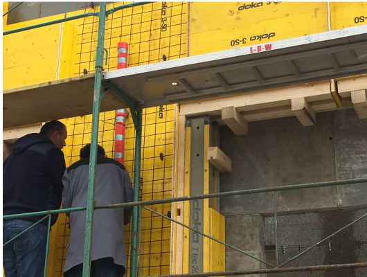
Bild 152 Ursache: Einlegen einer Bewehrungsmatte zur Befestigung des Regenwasserabflussrohres
