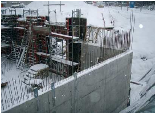
Bild 102 Ungeschützte Anschlussbewehrung rostet bei Niederschlag 520
