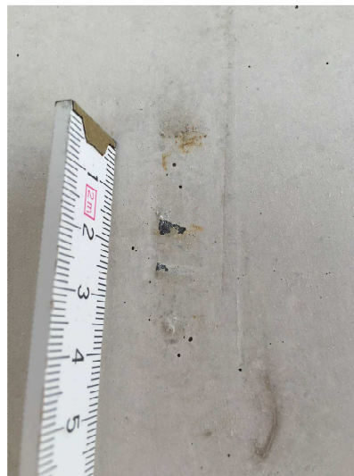
Bild 155 Wirkung: Abstandhalter nicht voll-kommen mit Beton umschlossen
