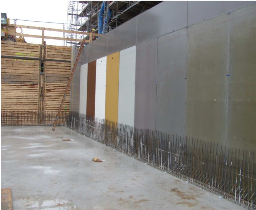
Bild 71 Ursache: Stellschalung mit unterschiedlichem Schalungshauttyp 409
