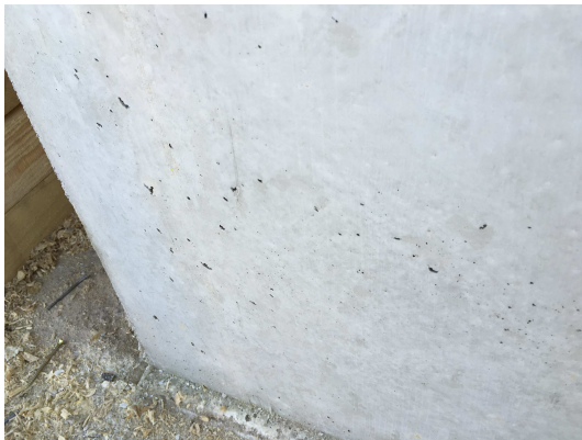
Bild 157 Wirkung: Erhöhte Poren- und Lunkerbildung im Fußbereich der Fassadenstützen
