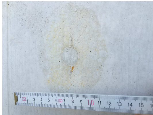
Bild 160 Fleckenbildung im Bereich eines Astloches der Schalhaut
