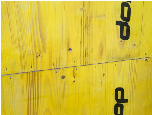
Bild 150 Ursache: Verschraubung der Schalhaut von der betonzugewandten Seite aus
