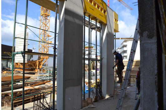
Bild 163 Ursache: Herstellung einer Aussparung durch den Einbau einer EPS-Platte im Fußbereich einer Fassadenstütze
