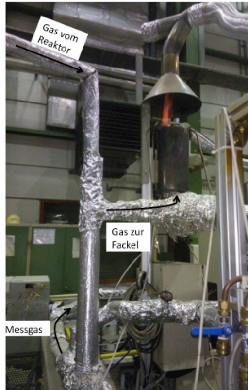
Abbildung 11: Gasleitung mit Fackel
