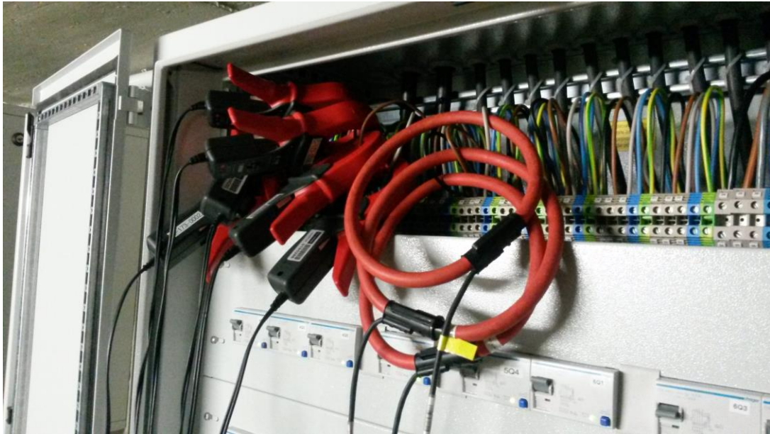
Abbildung 5.2 Messung der Ströme mittel Messzangen in den Zuleitungskabeln der Ladestationen
