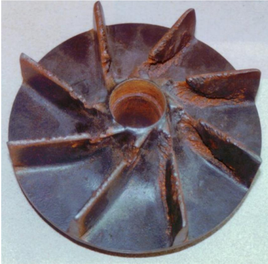
Abbildung 23: Kavitationserosion an einem Stahllaufrad, Quelle: http://www.processindustryforum.com [37]
