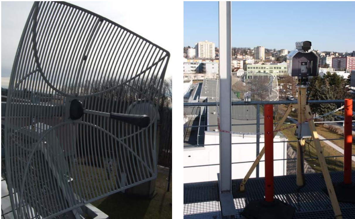
Abb. 6.5: Ansicht des Testaufbaus, Detail WLAN-Antenne (links), FSO-System (rechts)
