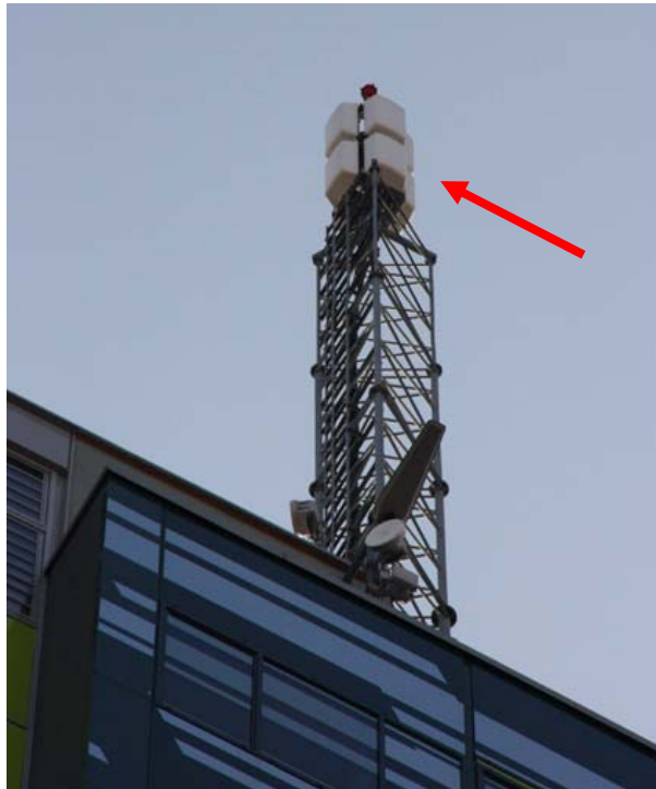
Abb. 2.14: DVB-T Sendeantenne auf einem Gebäude
