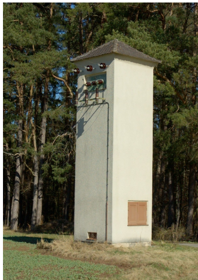
Abbildung 6.1: Ortsnetzstation über 20 kV Freileitung versorgt
