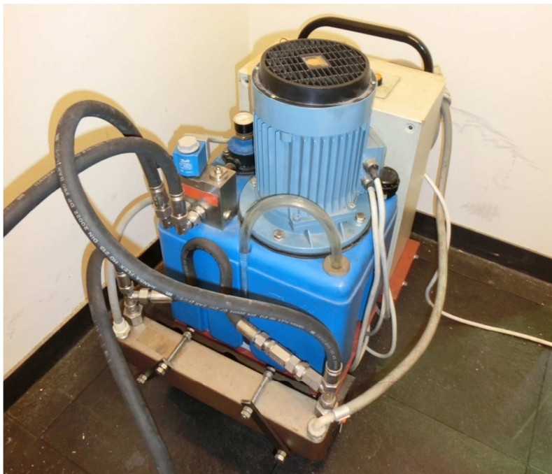
Bild 3.11: Wasseraggregat mit Schaltschrank und Kühler im Vordergrund
