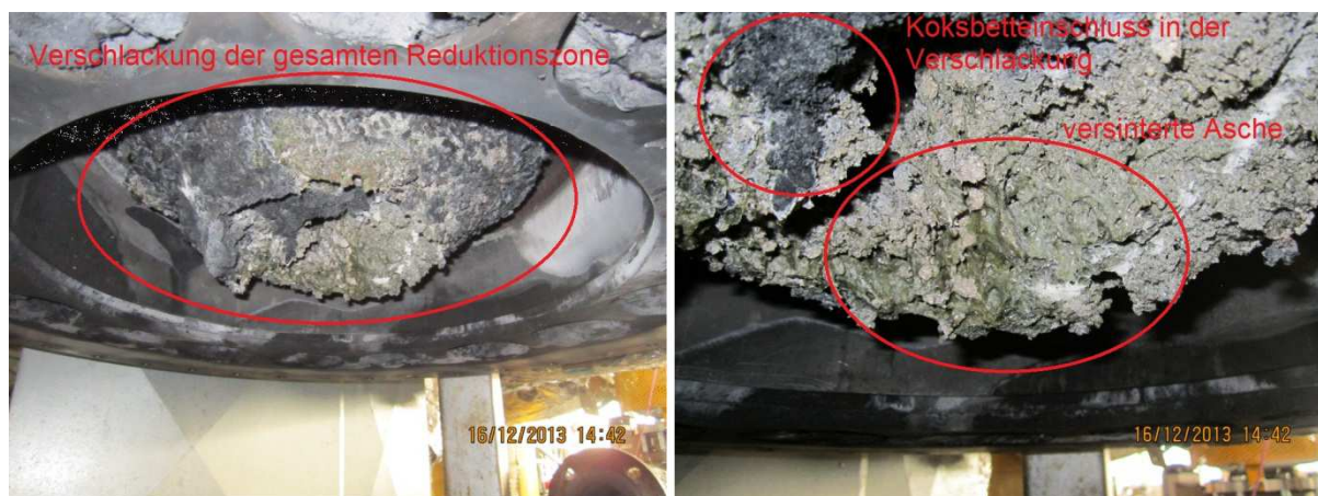
Abbildung 52: Anlageninspektion. Links: Verschlackung der Reduktionszone. Rechts: Nahaufnahme der Verschlackung
