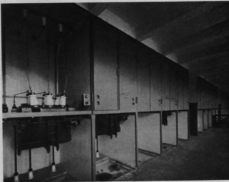
Abb. 420. Ölschalterraum mit qualmsicher abgeschlossenen Ölschalterzellen.
