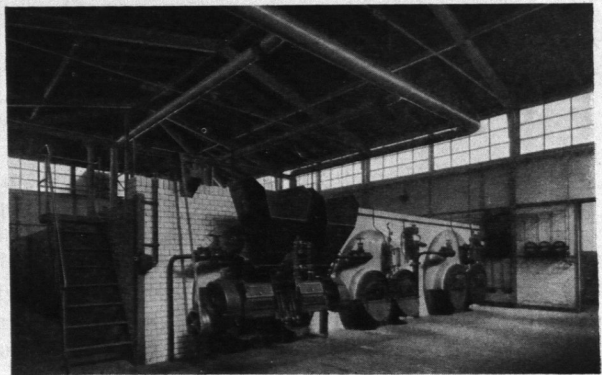
Abb. 380. Flammrohrkessel-Anlage; links ein Kessel mit Wurfffeuerung.
