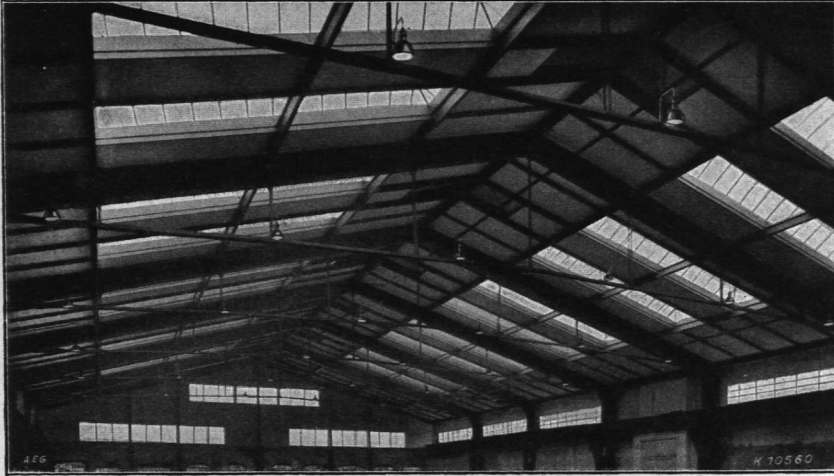
Abb. 345. Direkte Werkstattbeleuchtung in einer Halle; als Leuchten sind Tiefstrahler gewählt worden.
