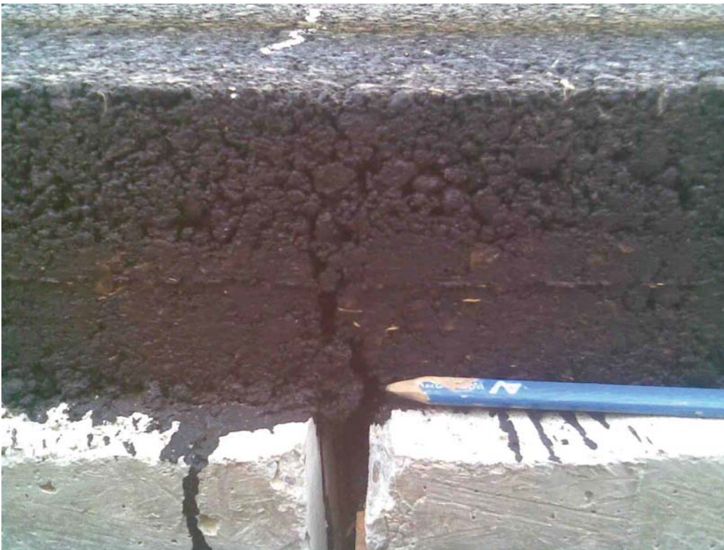
Abbildung 74 Riss 6 – Rissweite ~4 mm
