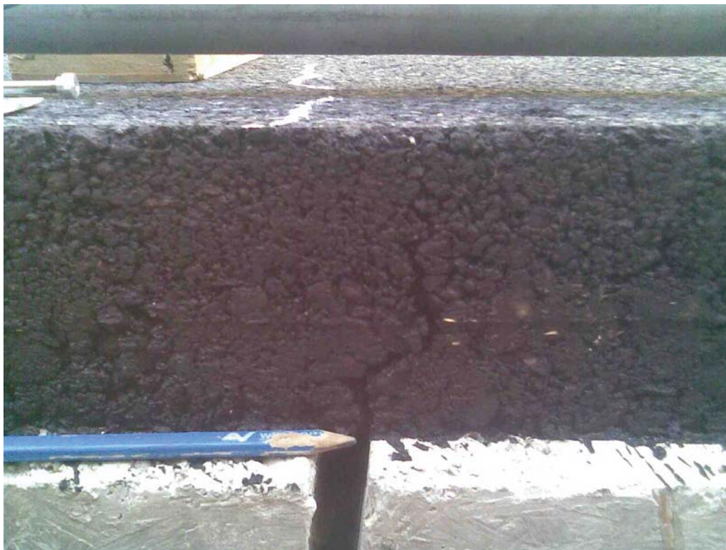
Abbildung 75 Riss 7 – Rissweite ~4 mm
