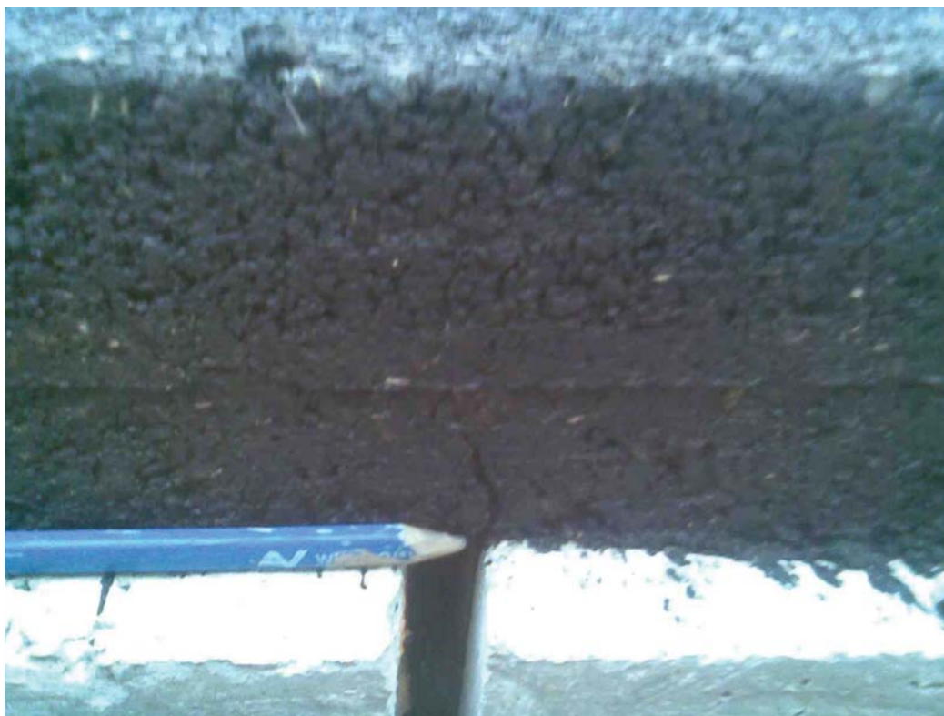
Abbildung 76 Riss 8 - Rissweite ~1,5mm
