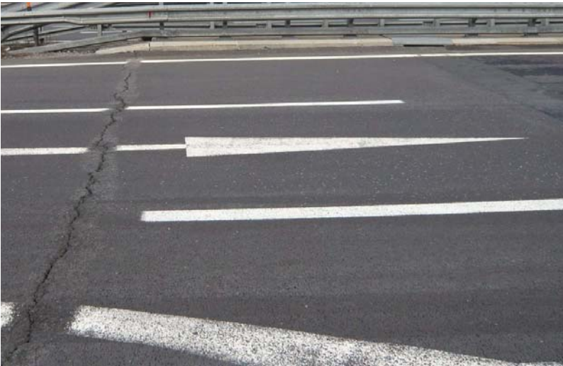
Abbildung 57. Risse im Bereich Übergang Schleppplatte – freie Strecke zufolge einer Widerlagerverformung
