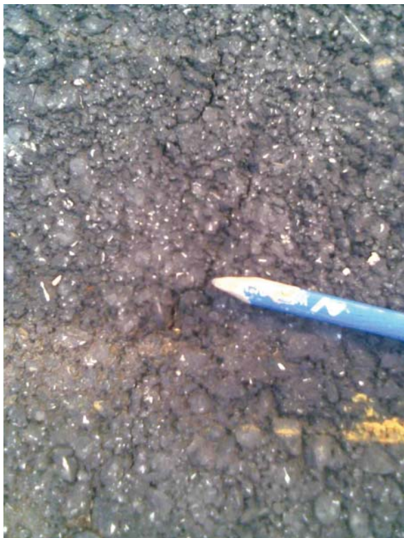
Abbildung 71 Riss 3 – Rissweite ~0,4 mm
