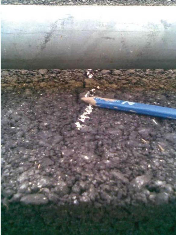
Abbildung 73 Riss 5 – Rissweite ~1 mm
