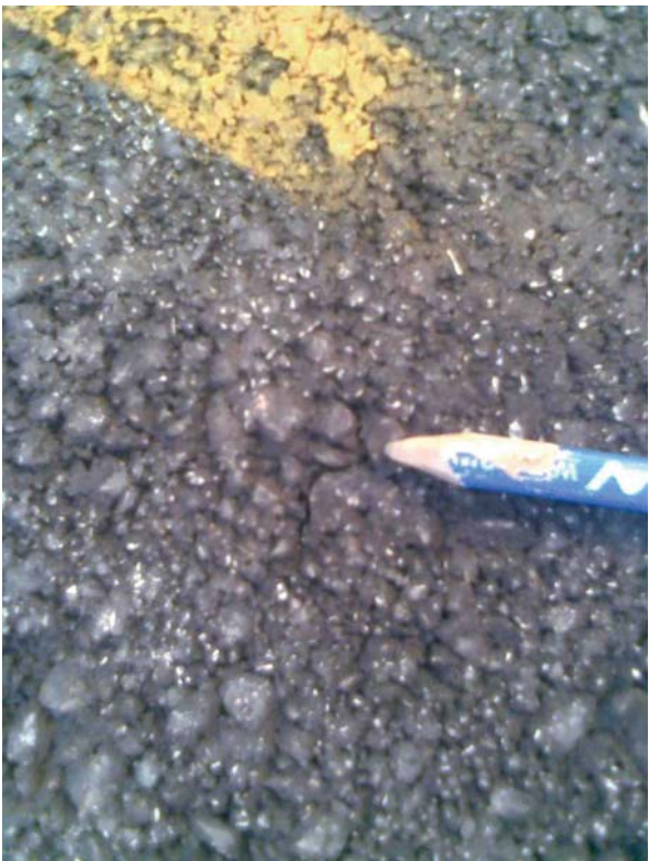
Abbildung 70 Riss 2 – Rissweite ~0,3 mm
