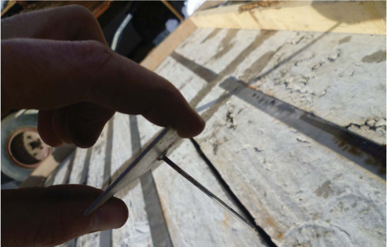
Abbildung 91. Fugenabdeckung mittels Blechstreifen mit Dorn Figure 91. Joint cover made of sheet metal strips with pin
