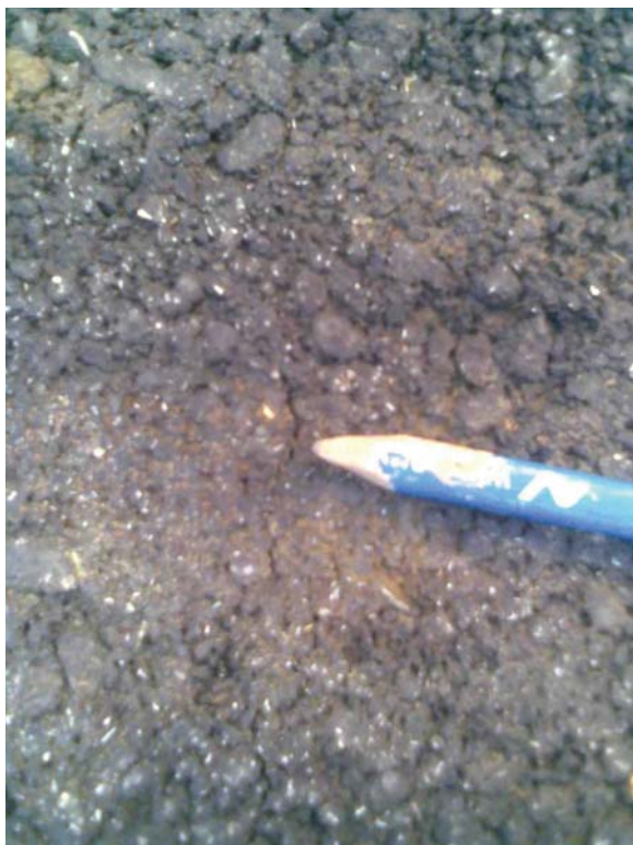
Abbildung 72 Riss 4 – Rissweite ~0,3 mm
