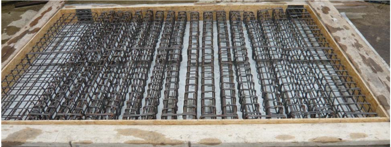
Abbildung 87. Ansicht der Bewehrung in der Schalung ohne Trenneinlagen Figure 87. View of the reinforcement in the formwork without joints dividers
