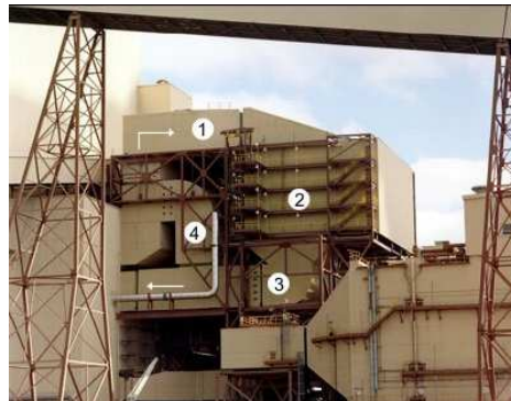
Abbildung 1: SCR-System in einem Kohlekraftwerk 1-Ammoniak ( \text{NH}_3 ) Einspritzung 2-SCR-Reaktor; 3-Gasaustritt 4-Reaktor Bypass [Quelle:Hitachi]
