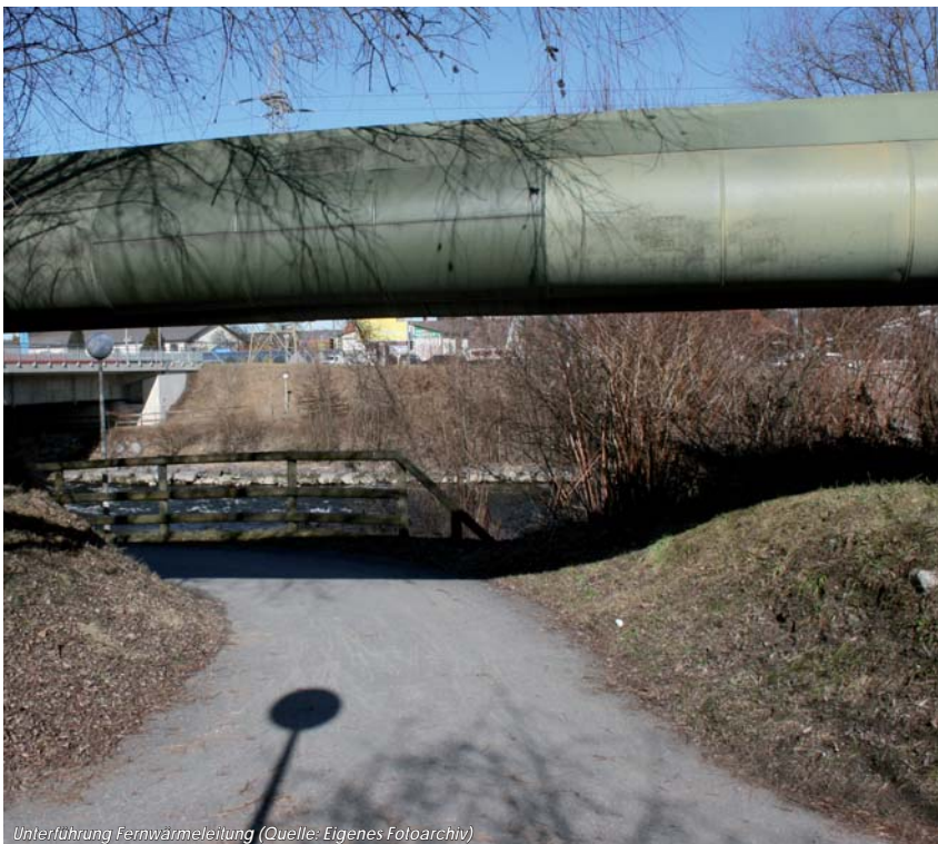
Unterführung Fernwärmeleitung (Quelle: Eigenes Fotoarchiv)
