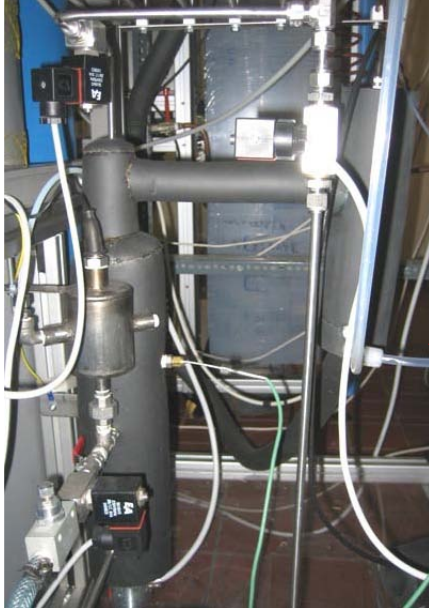
ABBILDUNG 6-4: DETAILANSICHT VOM BEFEUCHTER
