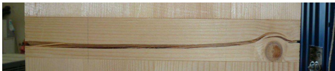
Abb. 3.8 Prüfkörper mit Flügelast (Ast ungeschädigt)
