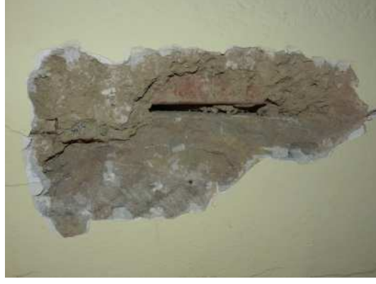
Abb 92 S26 durchgehende Putzschichten
