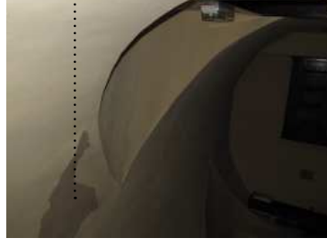
bereits abgeplattete Farbe.
