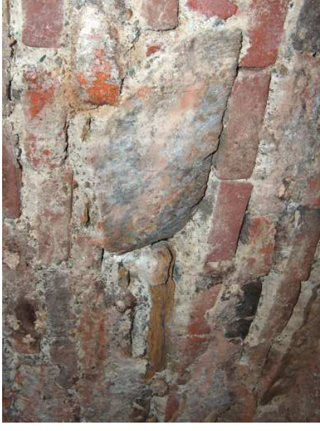
Abb 105 einzelne wenige Steine sind im Mauerwerk zu sehen
