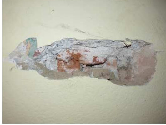
Abb 89/90 S27 Hier zeigt sich eine klare Trennung zwischen zwei Putzoberflächen die Öffnung Richtung Abortker hat somit noch nicht in der Hauptbauphase bestanden
