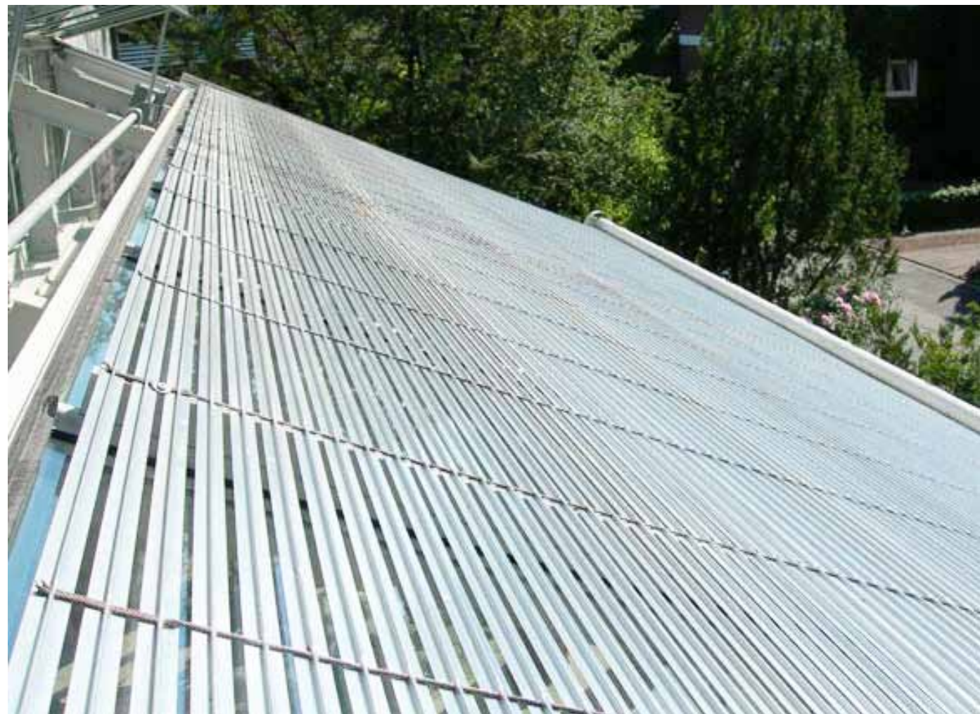
Abb.75 Der Sonnenschutz wird mittels Elektromotor betrieben.
