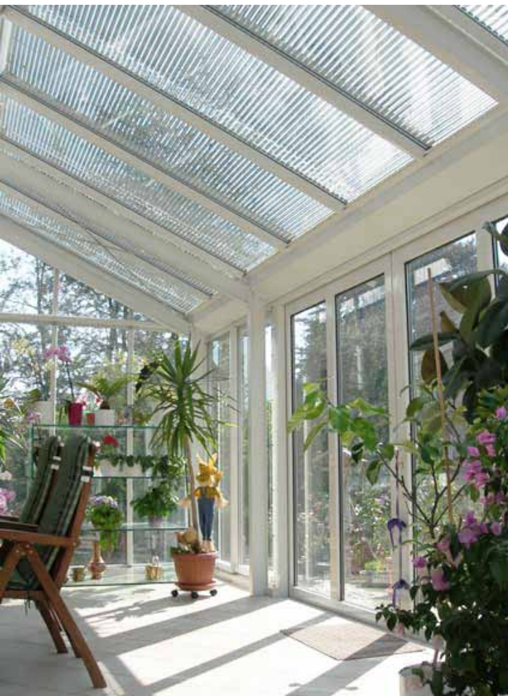
Abb.74 Außenliegender Sonnenschutz bei einem Wintergarten
