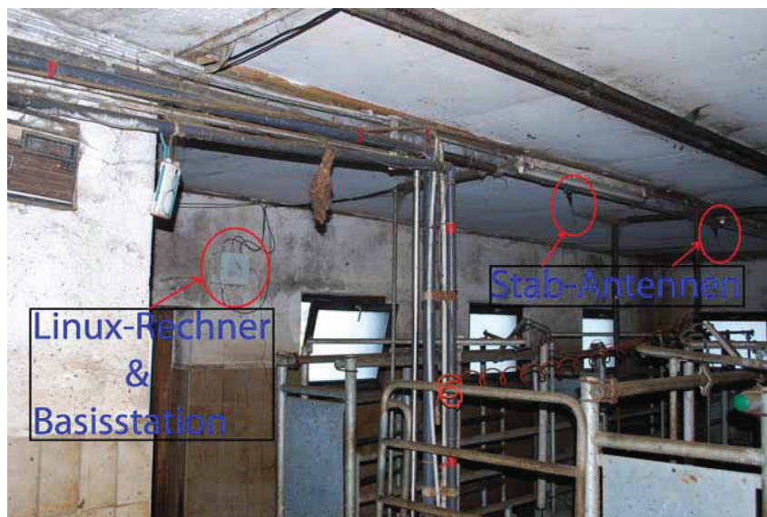
Abbildung 4.12: Lage der Stab-Antennen bei der Melkanlage
