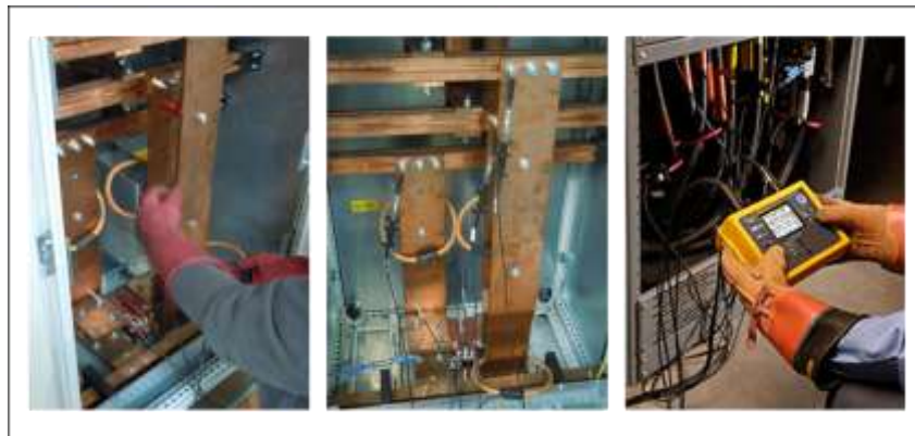
Abbildung 4-4: Einbau der Messgeräte Janitza-UMG 503 und Fluke-1735 188
